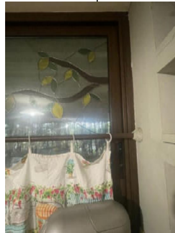
Foto n°19 - Dettaglio infissi cucina
