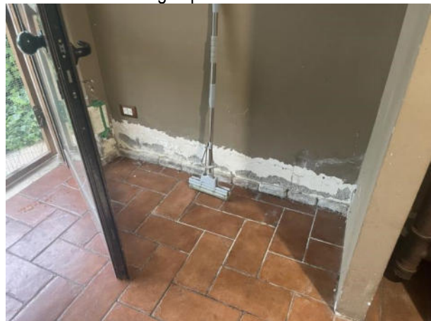
Foto n°27 - Risalita capillare piano seminterrato
