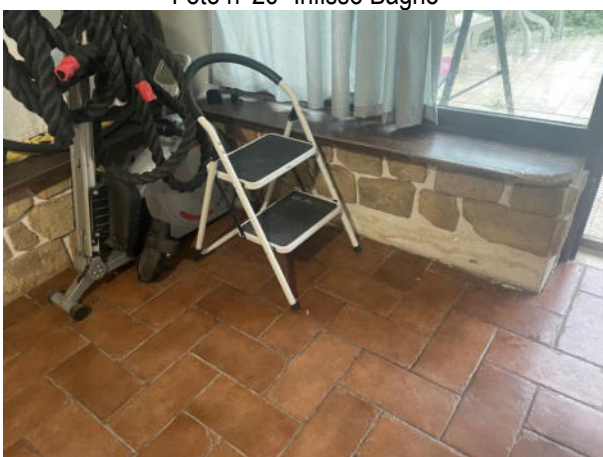
Foto n°28 - Risalita capillare piano seminterrato
