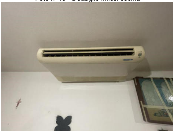
Foto n°20 - Condizionatore soggiorno/zona notte piano seminterrato
