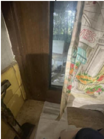
Foto n°18 - Dettaglio infissi cucina
