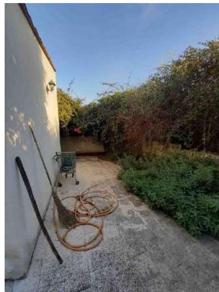
Foto 17- Foto Esterno Locale Tecnico
