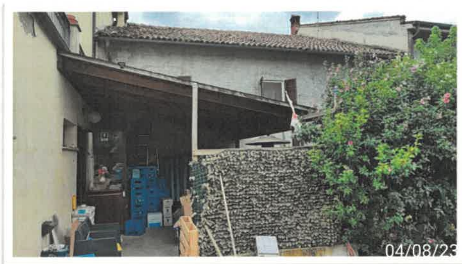
Tettoia su cortile posteriore da sanare
