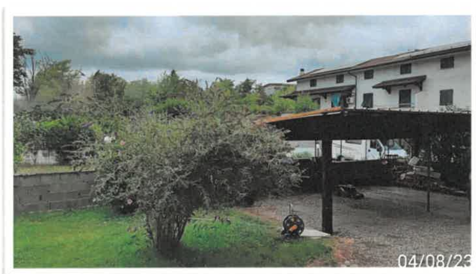
Tettoia ad uso ricovero auto da sanare
