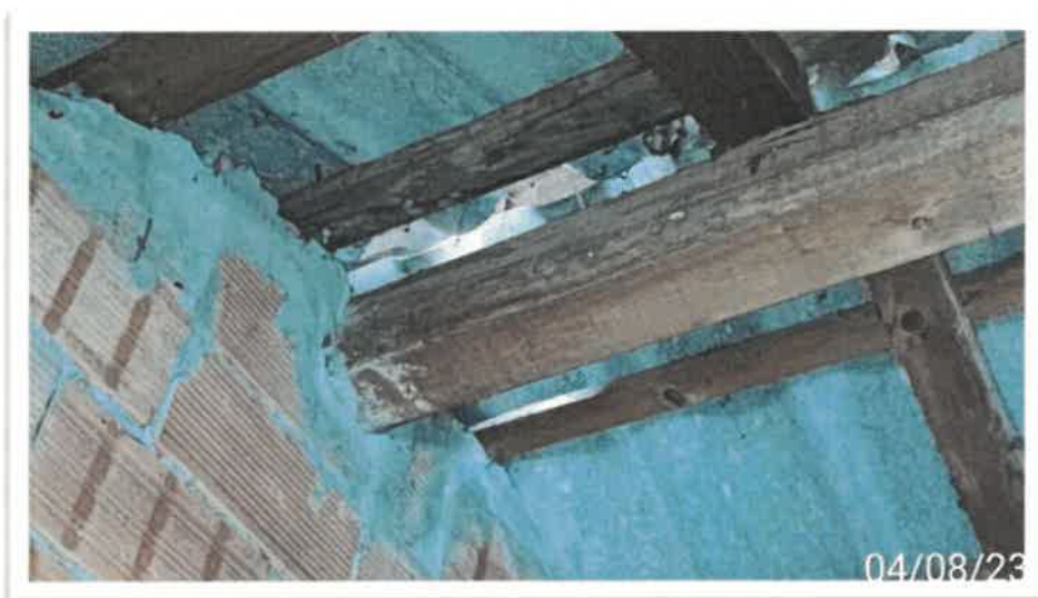
Sottotetto – Particolare infiltrazioni di acqua dal tetto causa coppi danneggiati e mancanza di scossaline
