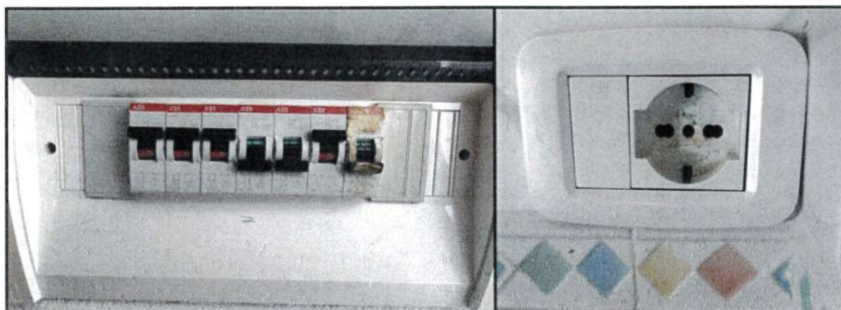
Impianto elettrico: quadro e presa elettrica nell'unità residenziale
