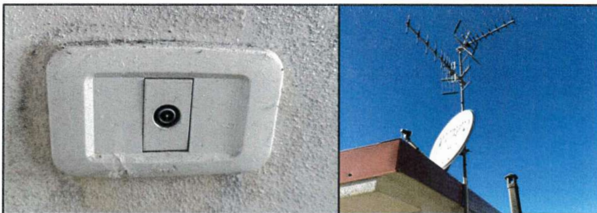
Impianto radiotelevisivo: antenne condominiali in copertura, presa antenna nell'immobile residenziale
