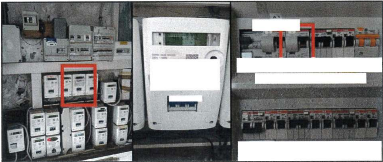
Impianto elettrico: alloggiamento contatore e differenziale per l'unità residenziale
