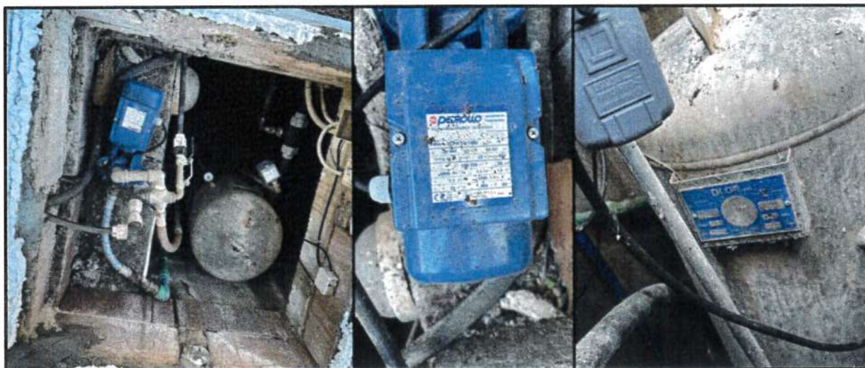
Impianto idrico: autoclave comune nella pertinenza tergaie
