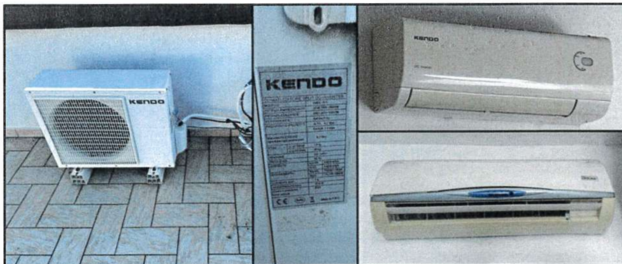
Impianto di climatizzazione: pompa di calore, split non funzionante, e secondo split disattivato.
