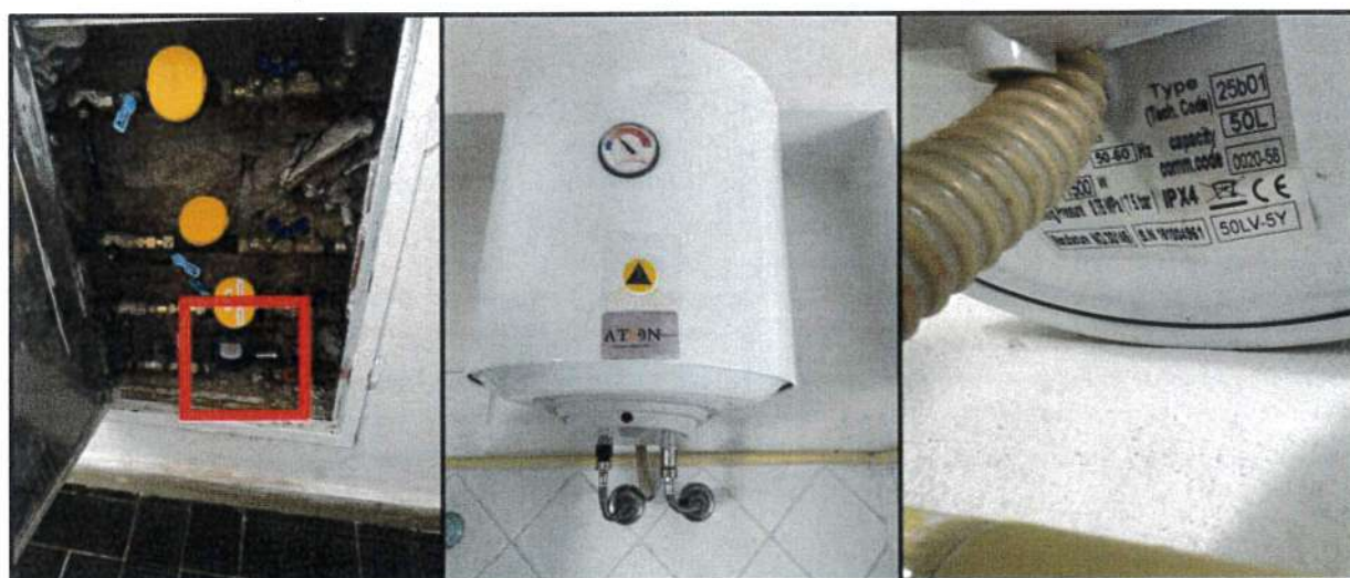
Impianto idrico: vano contatori e boiler per ACS
