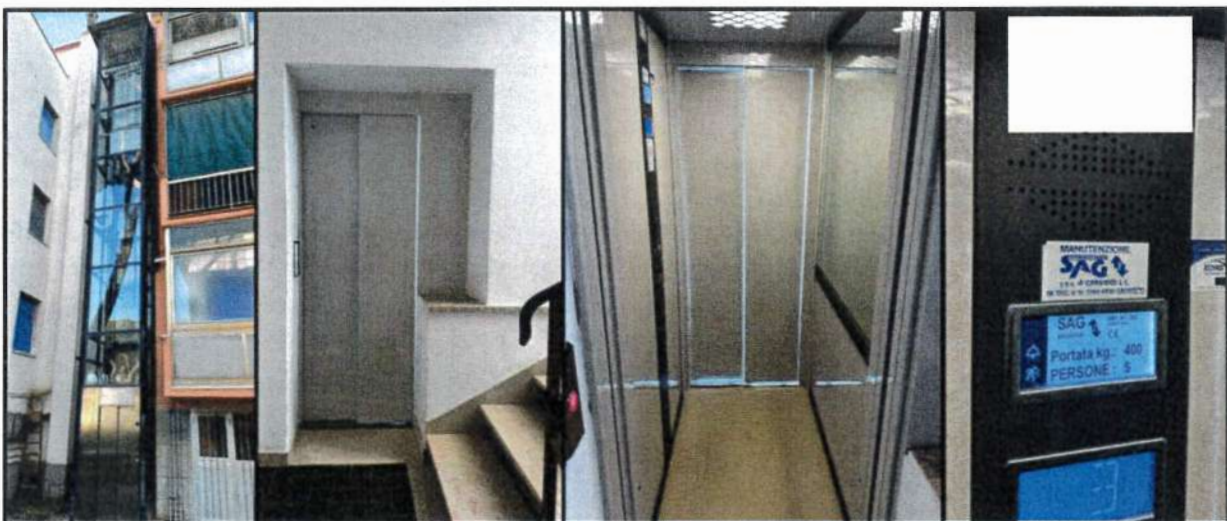
Impianto sollevamento: vista esterna dell'ascensore, cabina e dettaglio interno.
