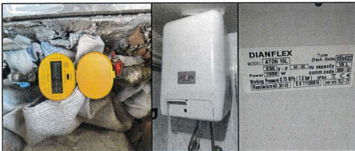
Impianto idrico: contatore e boiler per ACS in autorimessa
