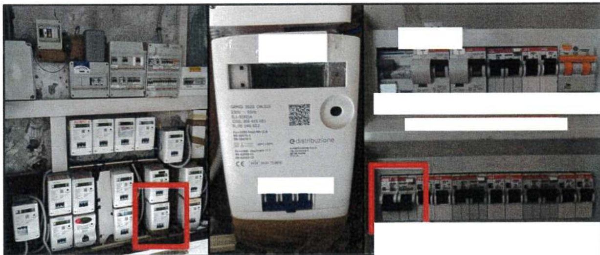
Impianto elettrico: alloggiamento contatore e differenziale per l'autorimessa
