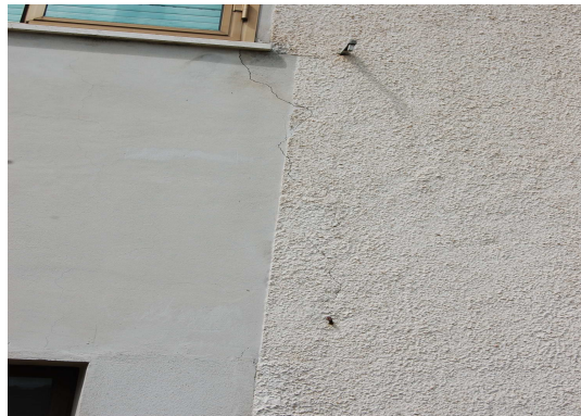
FOTO 10 – FESSURAZIONE SU MURATURA PORTANTE
