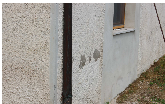
FOTO 5 – INTONACO AMMALORATO E CADENTE
