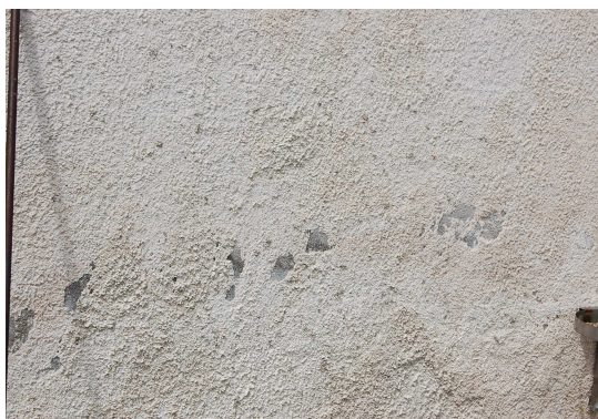
FOTO 4 – INTONACO AMMALORATO E CADENTE
