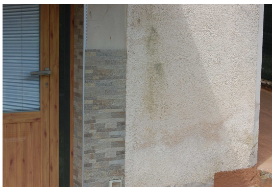
FOTO 3 – INTONACO AMMALORATO E CADENTE
