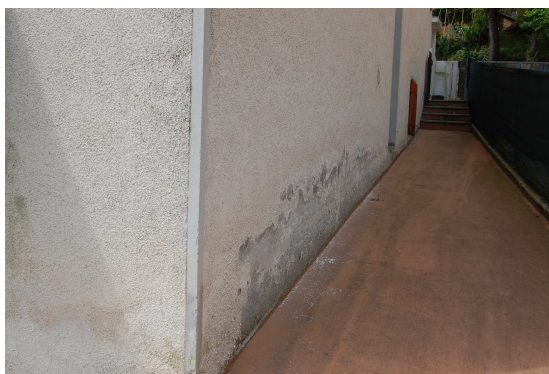
FOTO 2 – INTONACO AMMALORATO E CADENTE
