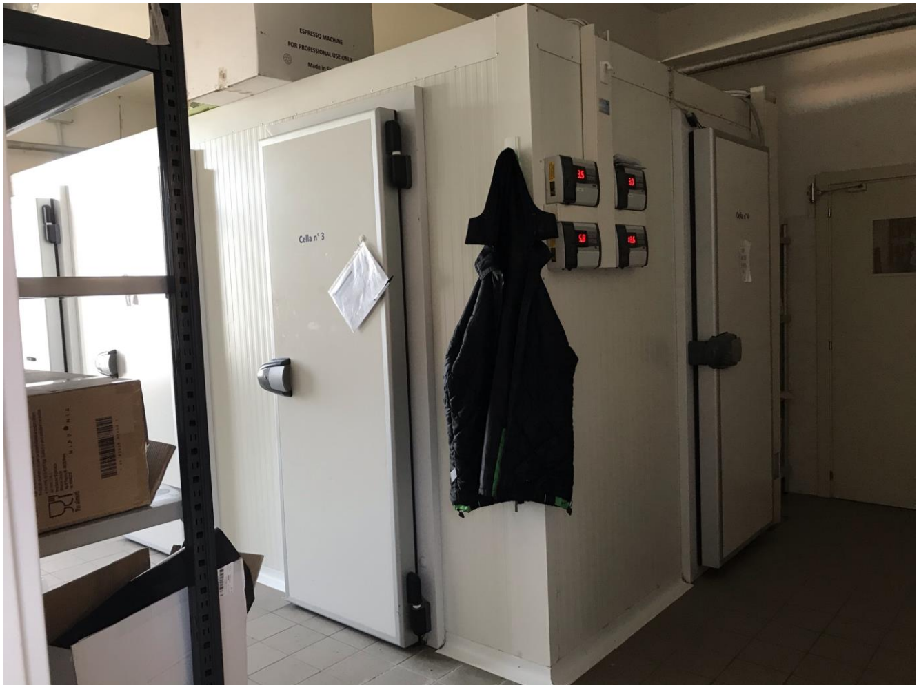
Vano tecnico lato cucina con cella frigorifera
