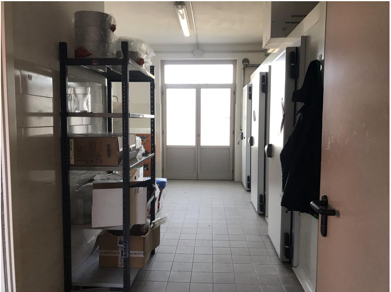
Vano tecnico lato cucina con cella frigorifera
