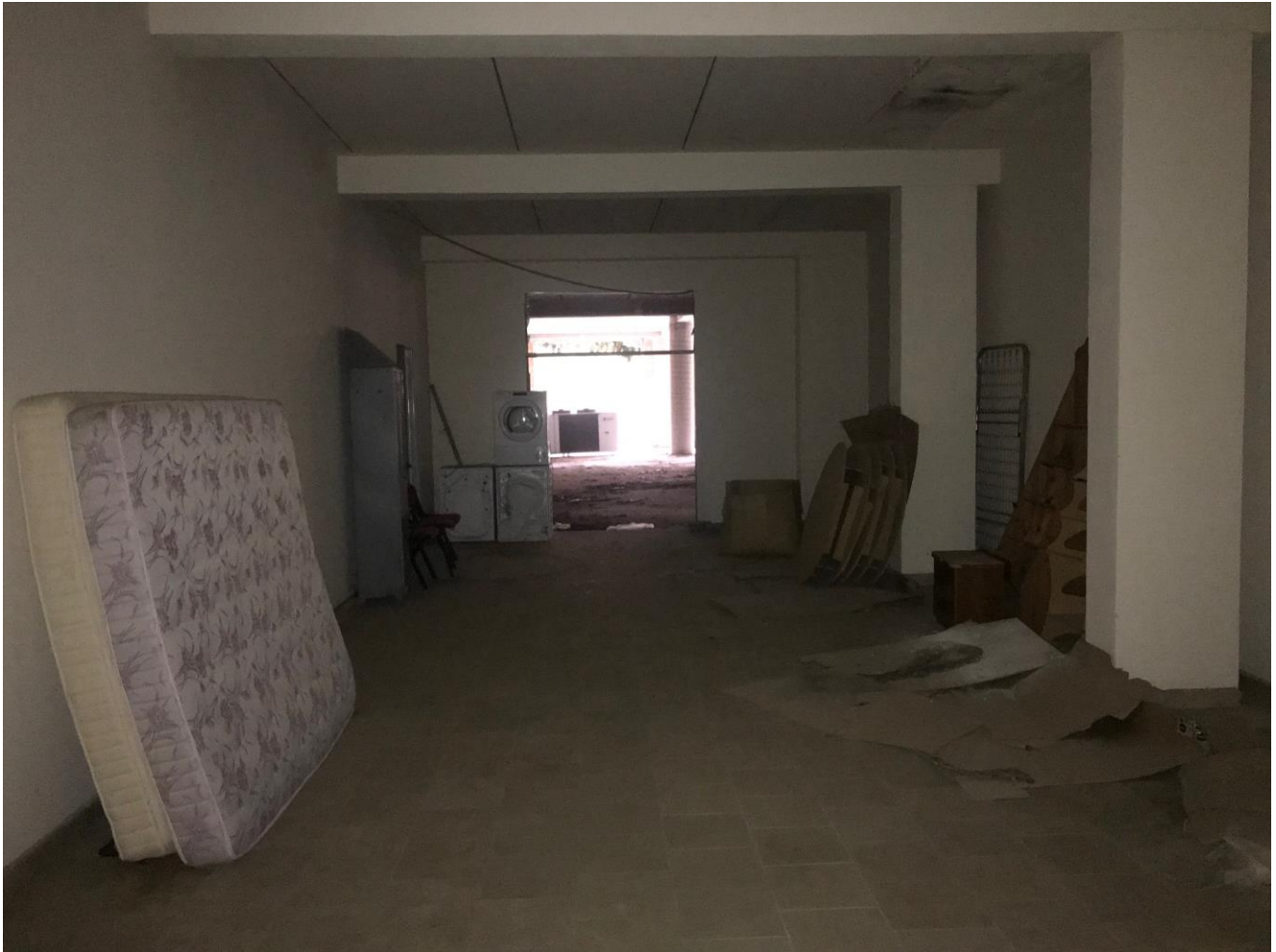
Magazzino incompleto senza infissi di chiusura verso area cantiere
