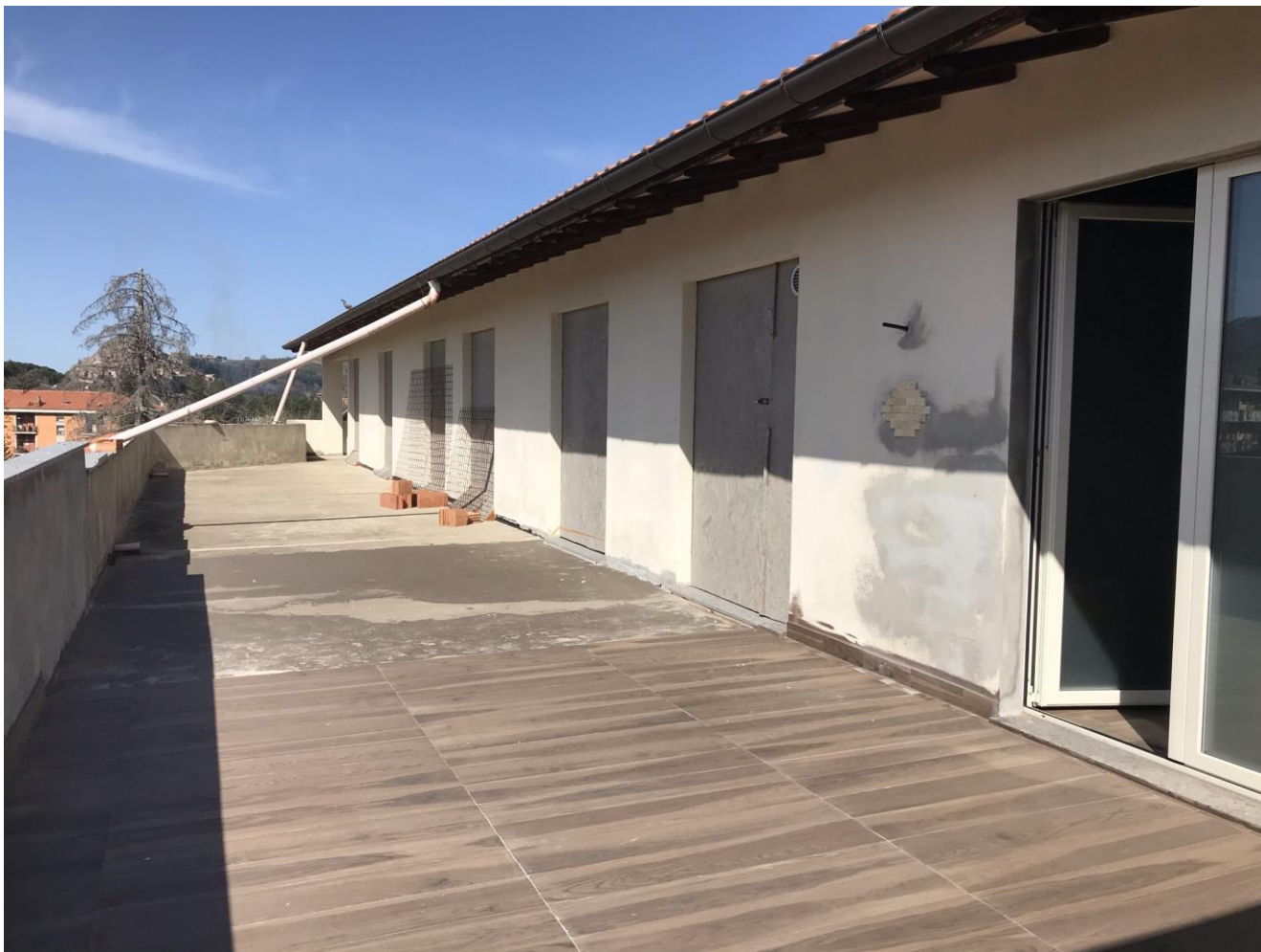
Zona adibita a centro benessere: porzione di terrazza realizzata nella parte da completare
