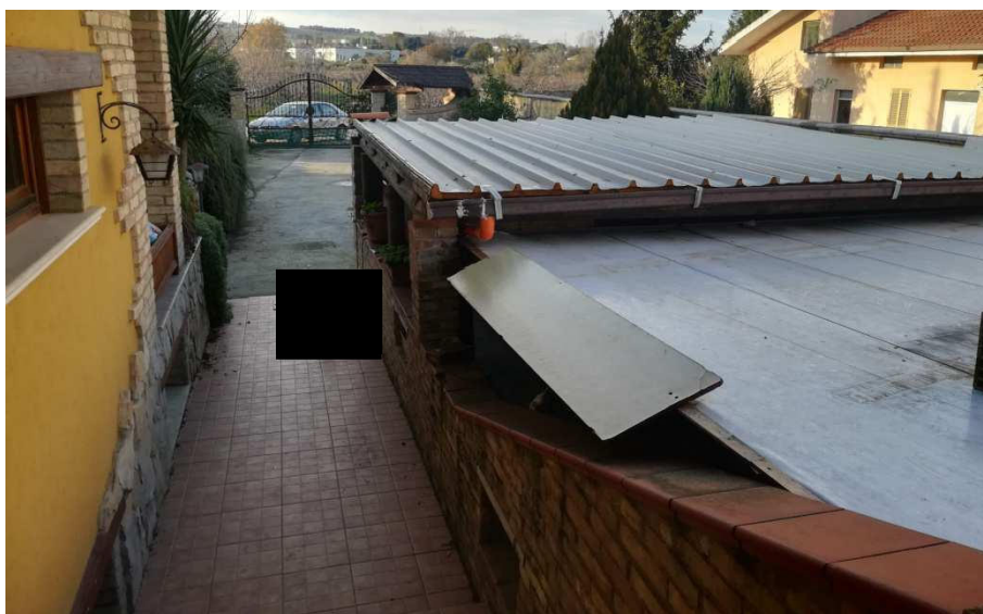
Copertura rampa d'accesso all'autorimessa - ABUSO
