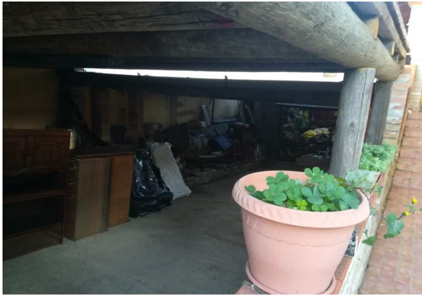
Copertura rampa d'accesso all'autorimessa - ABUSO
