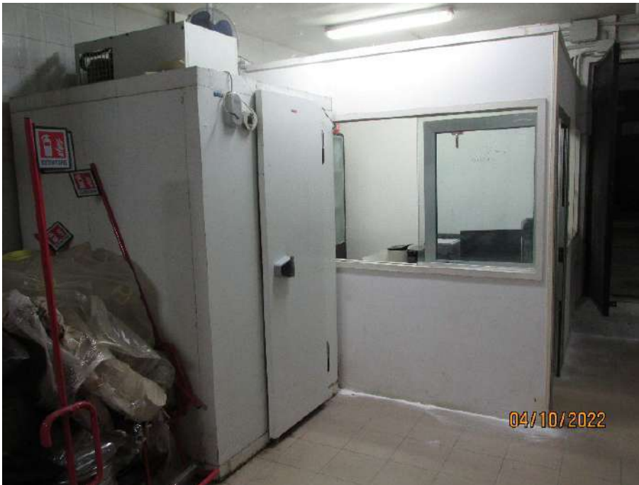
Fotografia 34 – Locale 2/a Sub 102 : nel locale è presente una cella frigorifera di modeste dimensioni.
