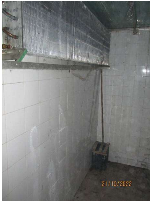
Fotografia 22 – Locale 1 Sub 101: Il locale non dispone di finestre ed è dotato di un apparato frigo ormai in disuso.
