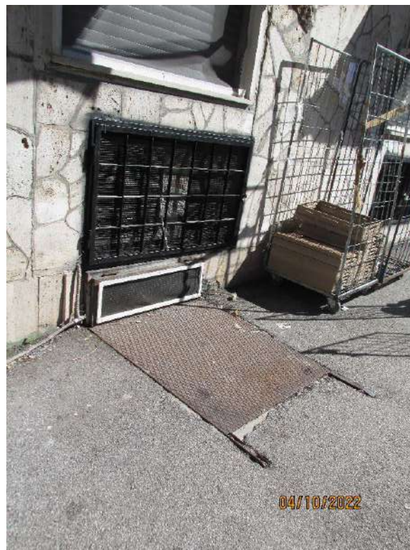
Fotografia 32 – Locale 2/a Sub 102 : Il punto di scarico merci risulta protetto esternamente sul marciapiede da una piastra in ferro removibile, mentre internamente al locale l'apertura è protetta da una cancellata in ferro.
