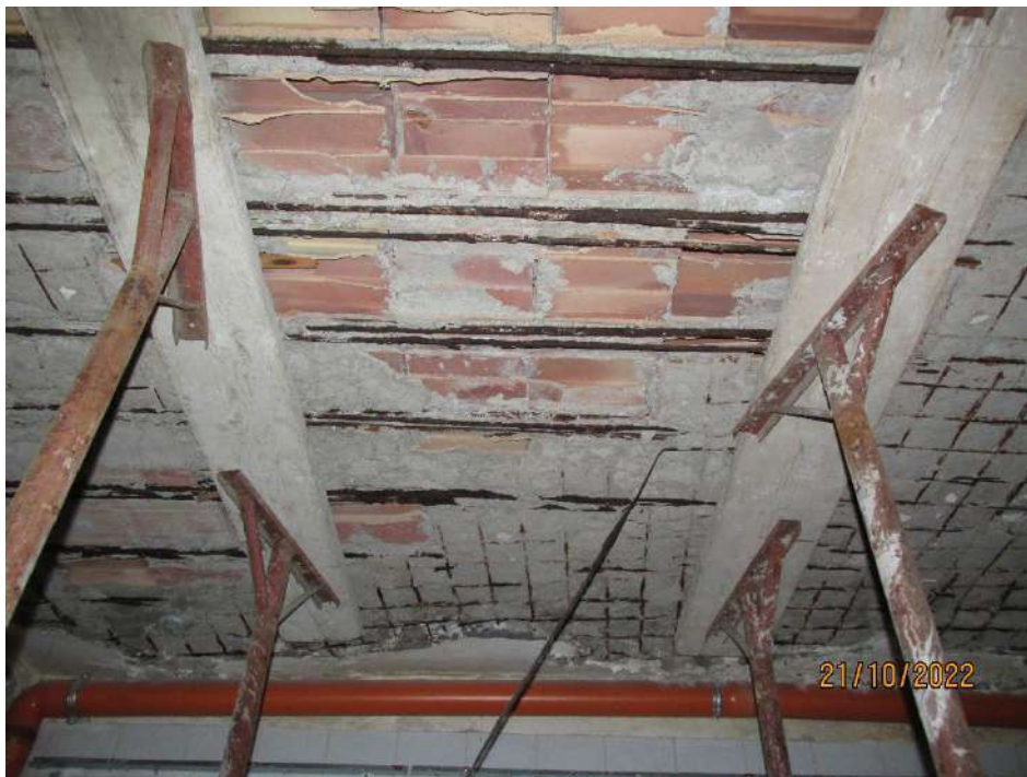
Fotografia 37 – Locale 2/b Sub 102: Il locale versa in pessime condizioni di manutenzione, dovuto soprattutto all'avanzato stato di degrado dell'intradosso del solaio, il quale risulta puntellato per quasi la metà della sua superficie, con tavole di legno e puntelli telescopici in ferro.
