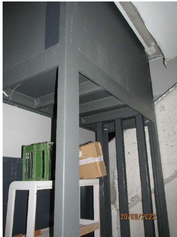
Fotografia 17 – Nel disimpegno del piano interrato che conduce ai tre locali, è installata la struttura portante in ferro dell'ascensore condominiale, ma non è presente alcuna fermata dell'ascensore.
