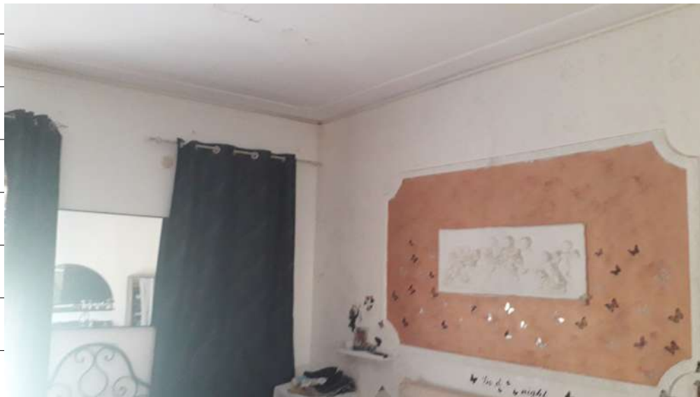
Foto n.11: immagine interna della camera da letto ubicata al piano primo dell'immobile sito in via Sassari n.17 a Lentini.
