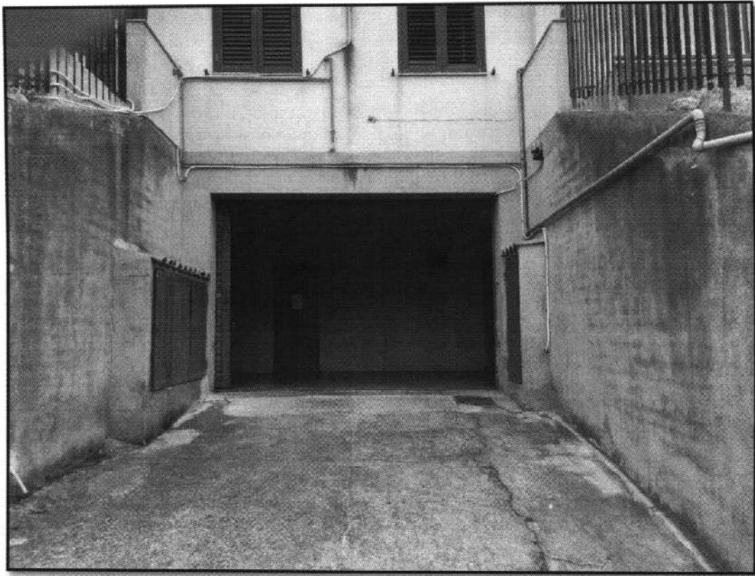
LOTTO 001- Corpo B - FOTO 16 – AGIRA - Foglio 34 - Particela 380 - Sub. 13 - Vista ingresso ai box condominiali
