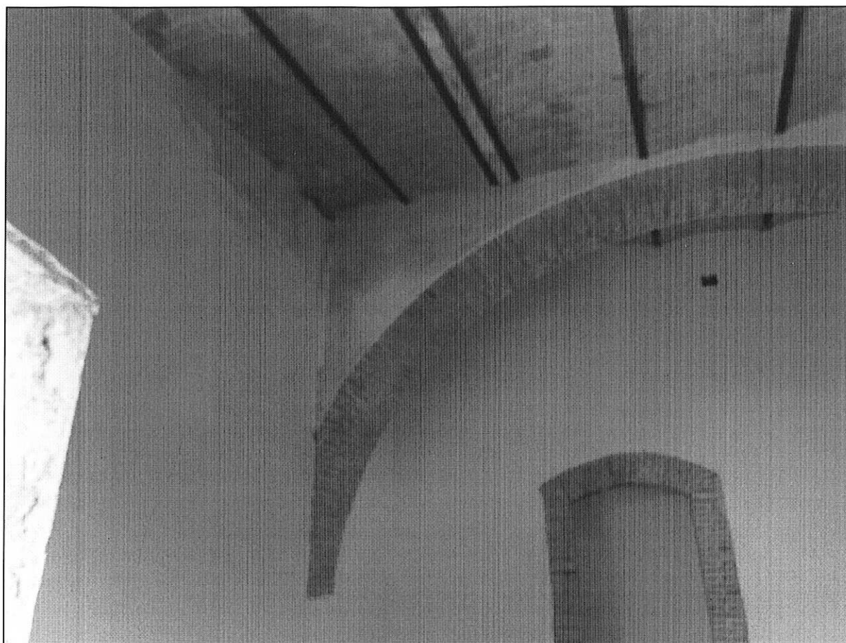
Figura 25. Solaio a voltine su travi in acciaio, sul quale cominciano a comparire macchie di infiltrazioni.
