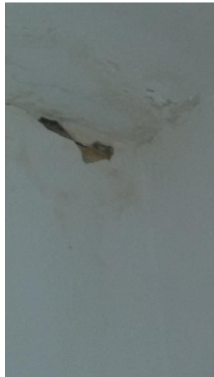
Danno per infiltrazione soffitto
