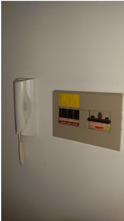
Comandi degli impianti
