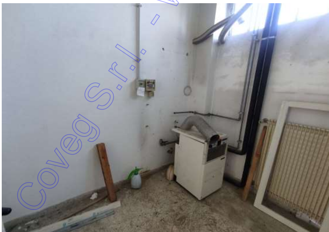
Caldaia C.T. (fuori servizio)
