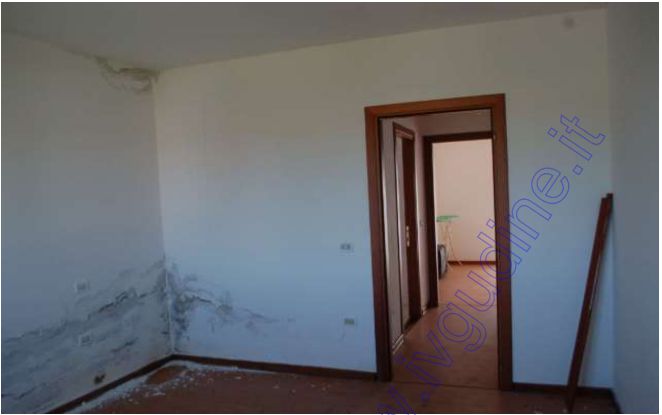
Vano con evidenti segni di umidità
