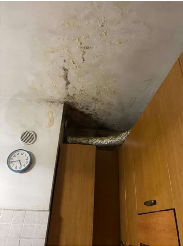
FOTO 15: Infiltrazioni e muffa in cucina
