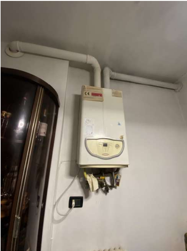
FOTO 13: Caldaia ubicata in cucina
