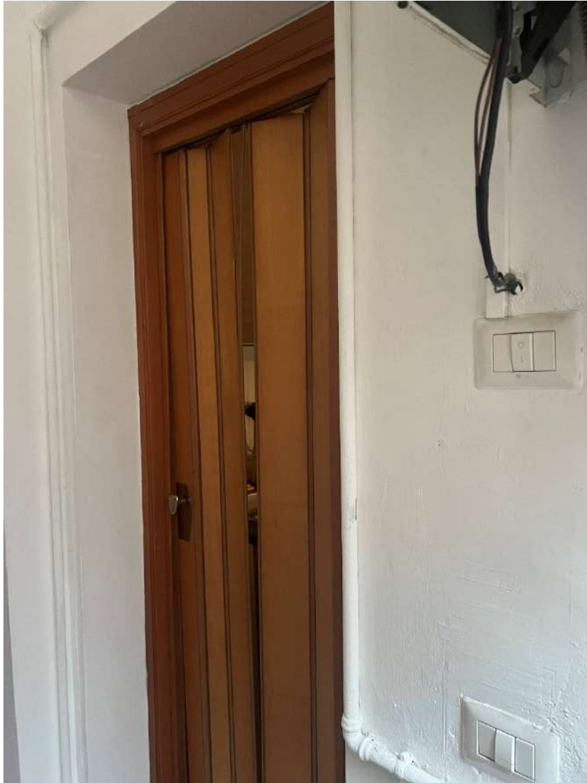
Foto 17 – Balcone chiuso adibito a wc
