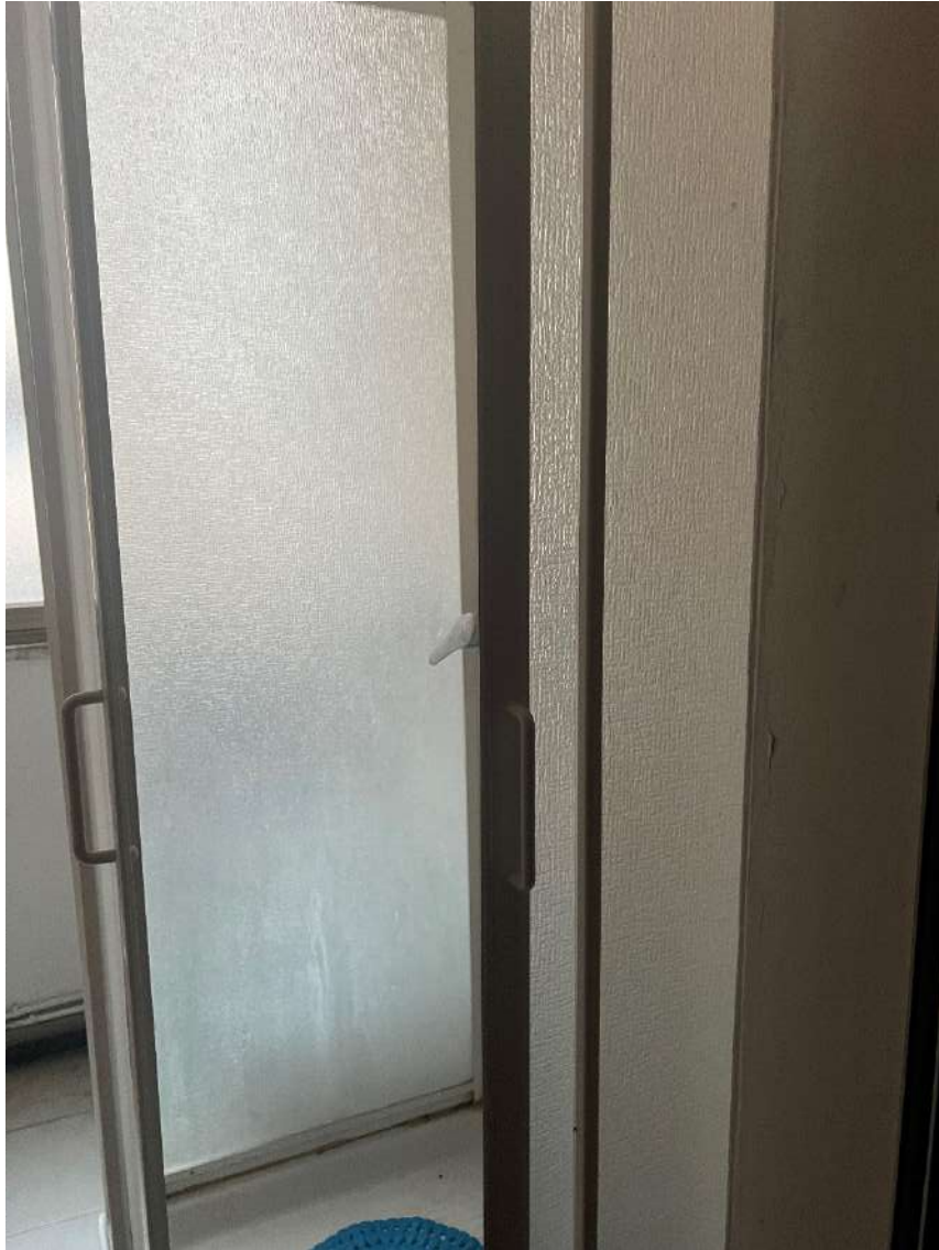
Foto 19 – Balcone chiuso adibito a wc
