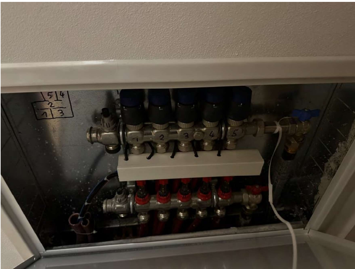
Collettore impianto radiante a pavimento
