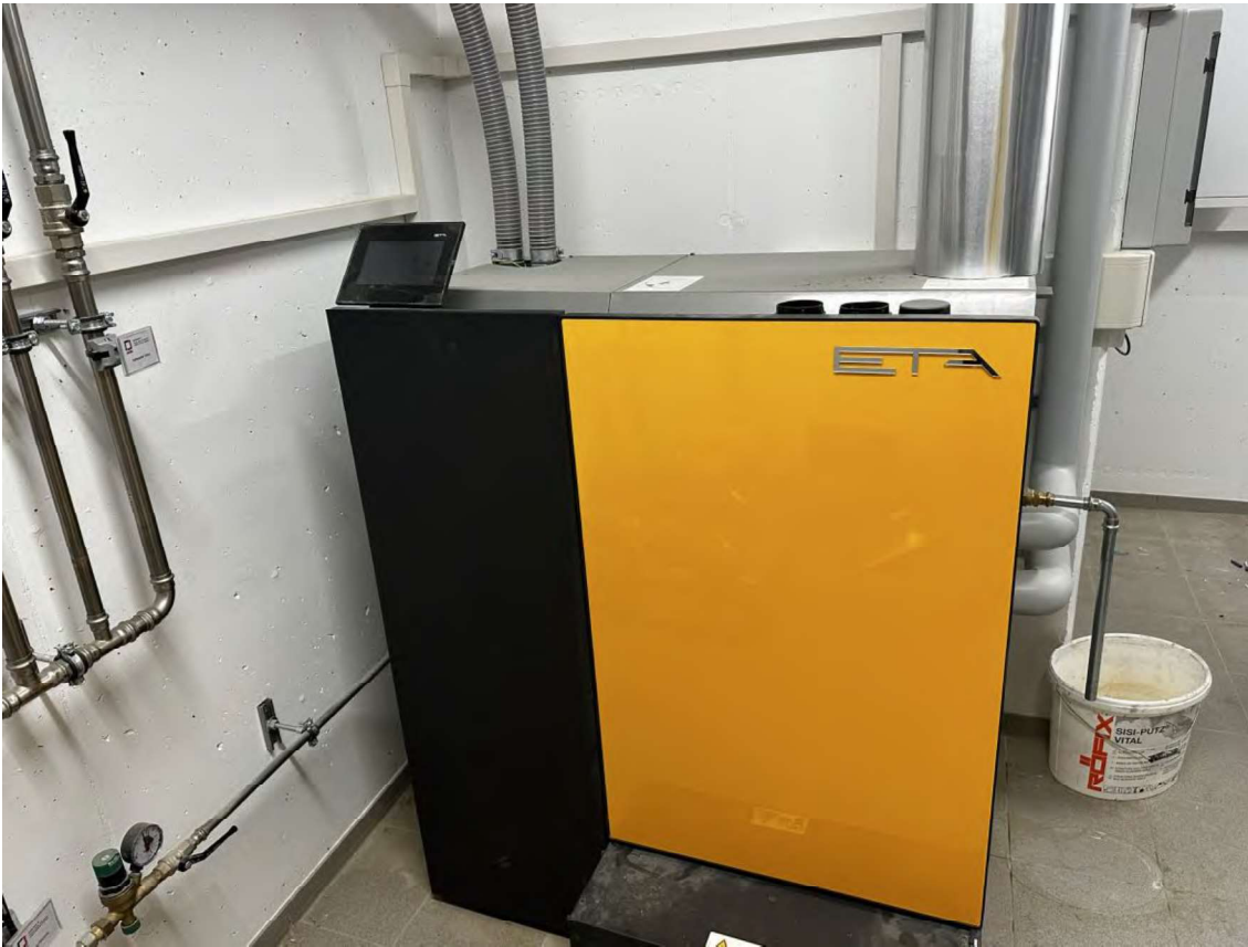
Caldaia a pellet
