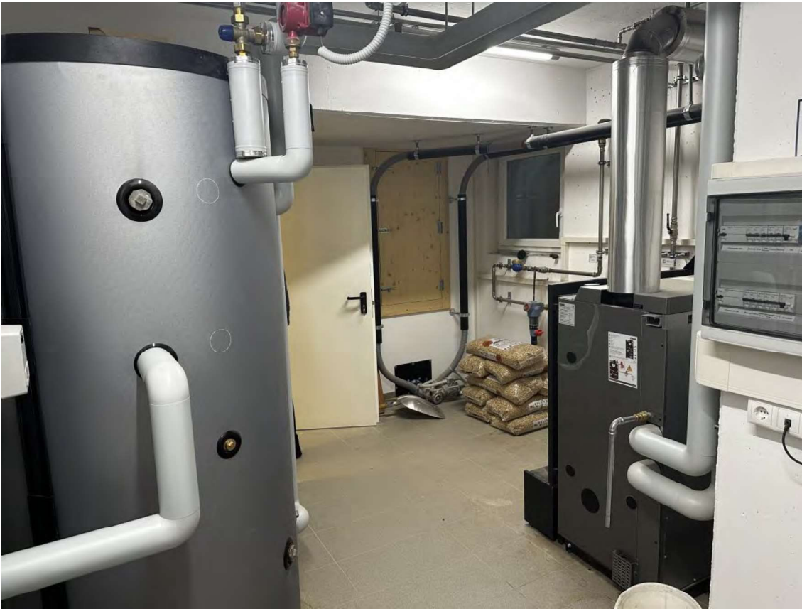
Centrale termica con silos pellet
