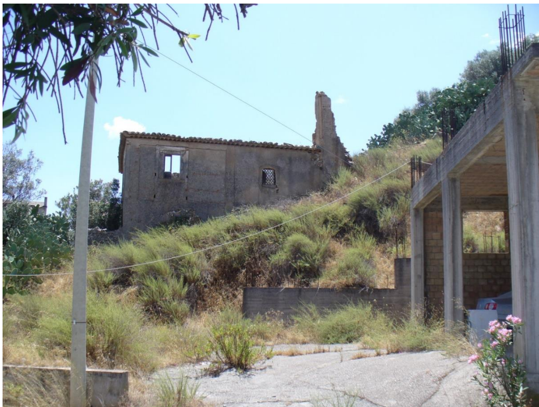
FOTO N. 17 – fabbricato diruto fg 10 part. 4 -
