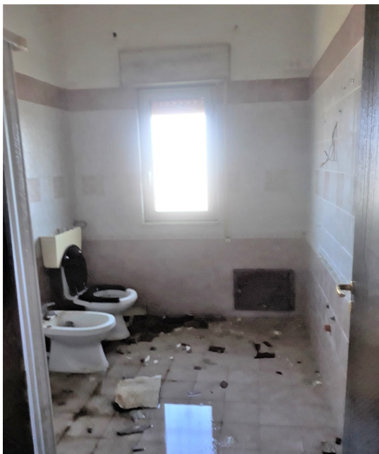
9. Villino originario. Le condizioni del bagno. Si nota il riflesso della finestra nel pavimento bagnato dalle vaste infiltrazioni dal soffitto sfondellato e le macerie.
