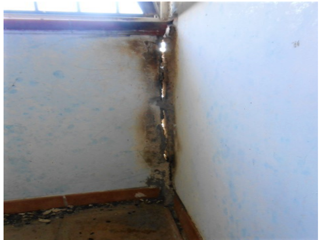
18. Ampliamento lato Nord-Est. Particolare del grave distacco verticale della muratura dal villino originario (a destra).
