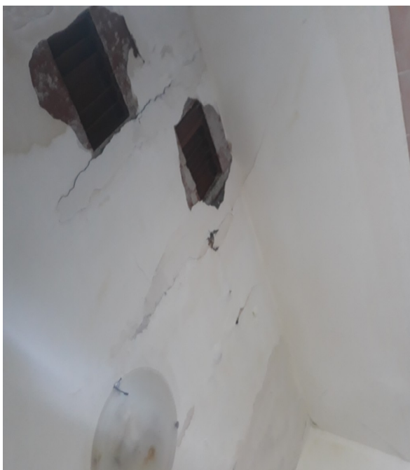
11. Villino originario. Il soffitto sfondellato del vano wc/doccia
