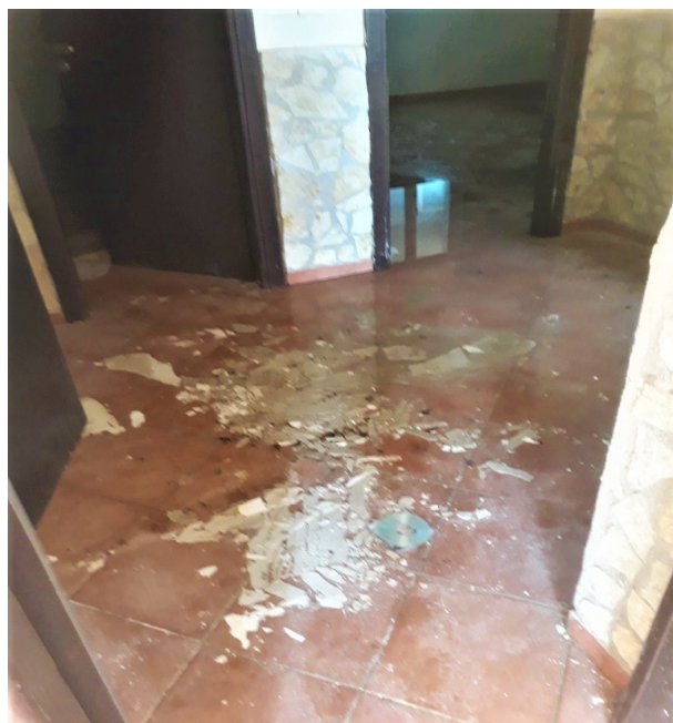
12. Villino originario. Il pavimento bagnato del disimpegno ricolmo di macerie di intonaci caduti dal soffitto per infiltrazioni
