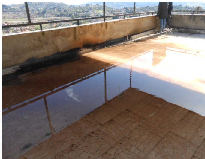
22. Villino originale. Il lastrico solare allagato per occlusione dello scarico delle acque meteoriche.
