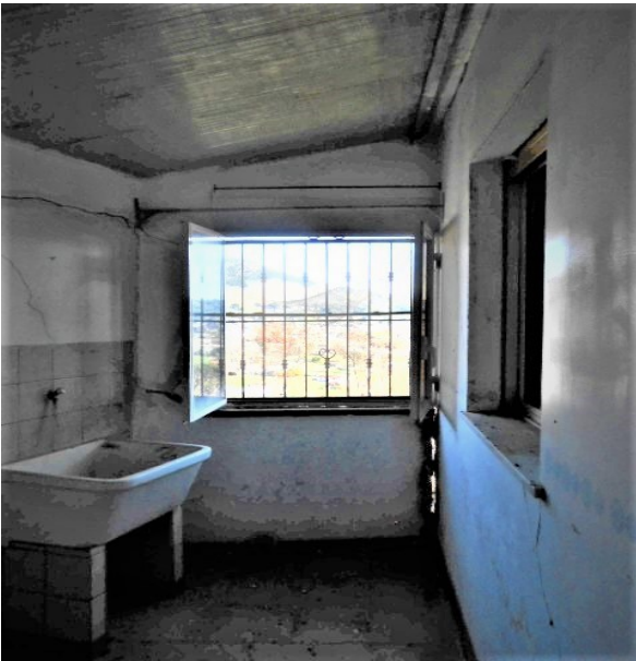
19. Ampliamento lato Nord-Est, gravi fratture macroscopiche diffuse e degrado. Si nota il distacco verticale della muratura dal villino originario (a destra).
