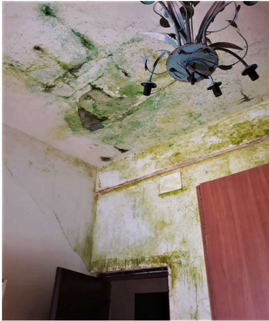
7. Villino originario. Muffe umide nel soffitto e nelle pareti
