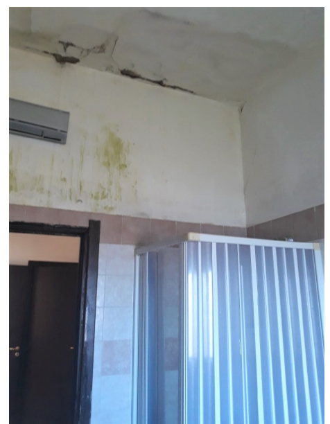
10. Villino originario. Le condizioni del soffitto e parete nell'angolo doccia.
