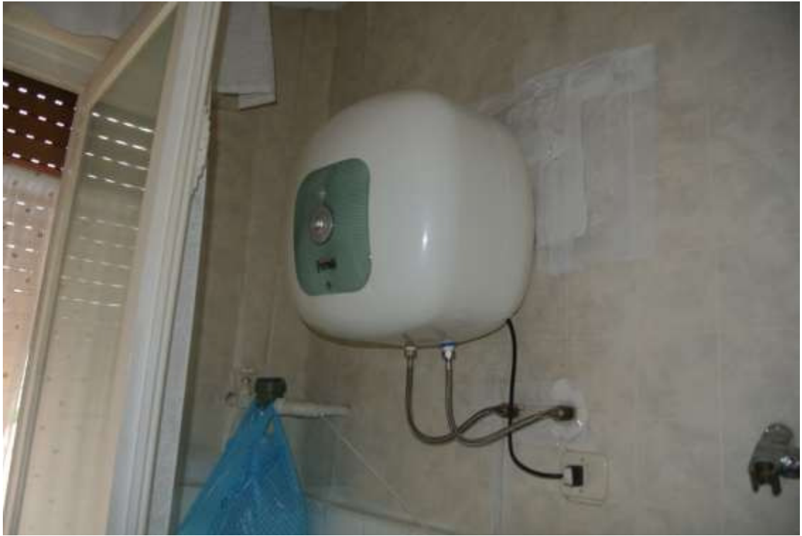
FOTO 13—particolare boiler per acqua calda
