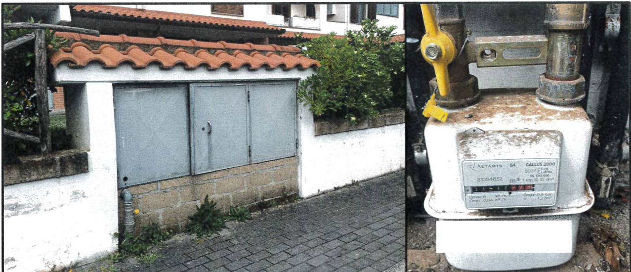
Impianto a gas: fornitura e contatore
