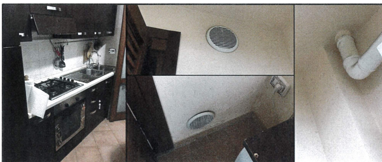
Impianto a gas: cucina, fori di areazione e ventilazione, canna fumaria condominiale
