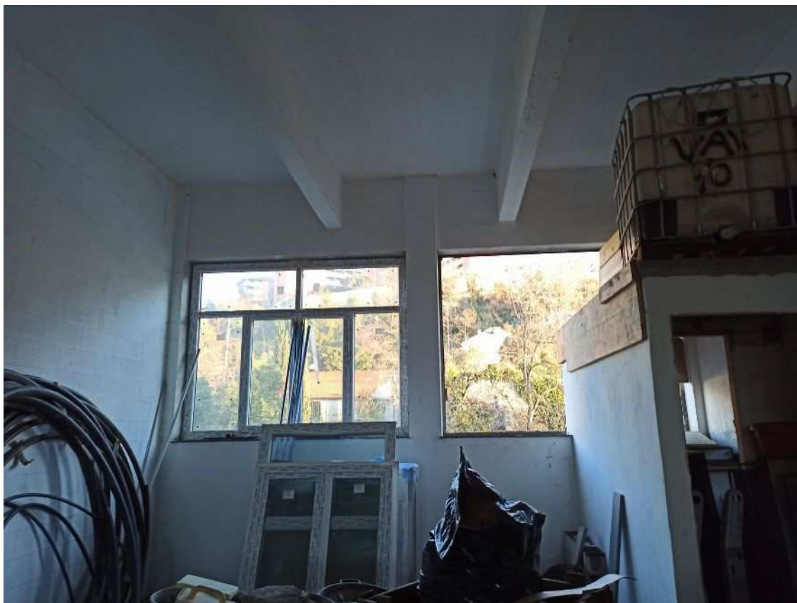
Foto 10: Mancanza di infissi esterni
