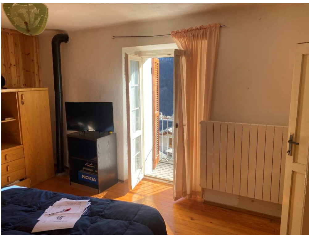
Particolare tubo caldaia passante nella camera.
