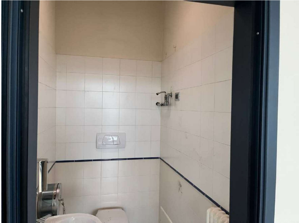
Figura 1 – caldaia murale asportata al piano primo
