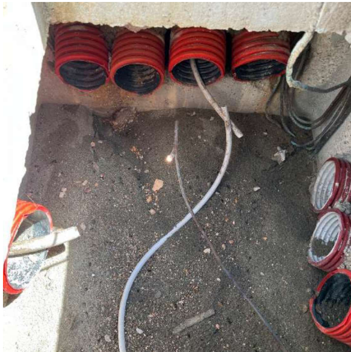
Figura 11- cavi tagliati e sfilati nei pozzetti esterni interrati
