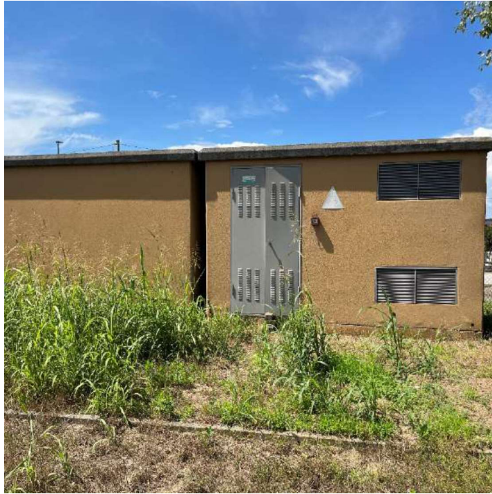
Figura 12 cabina elettrica lato utente con serratura divelta
