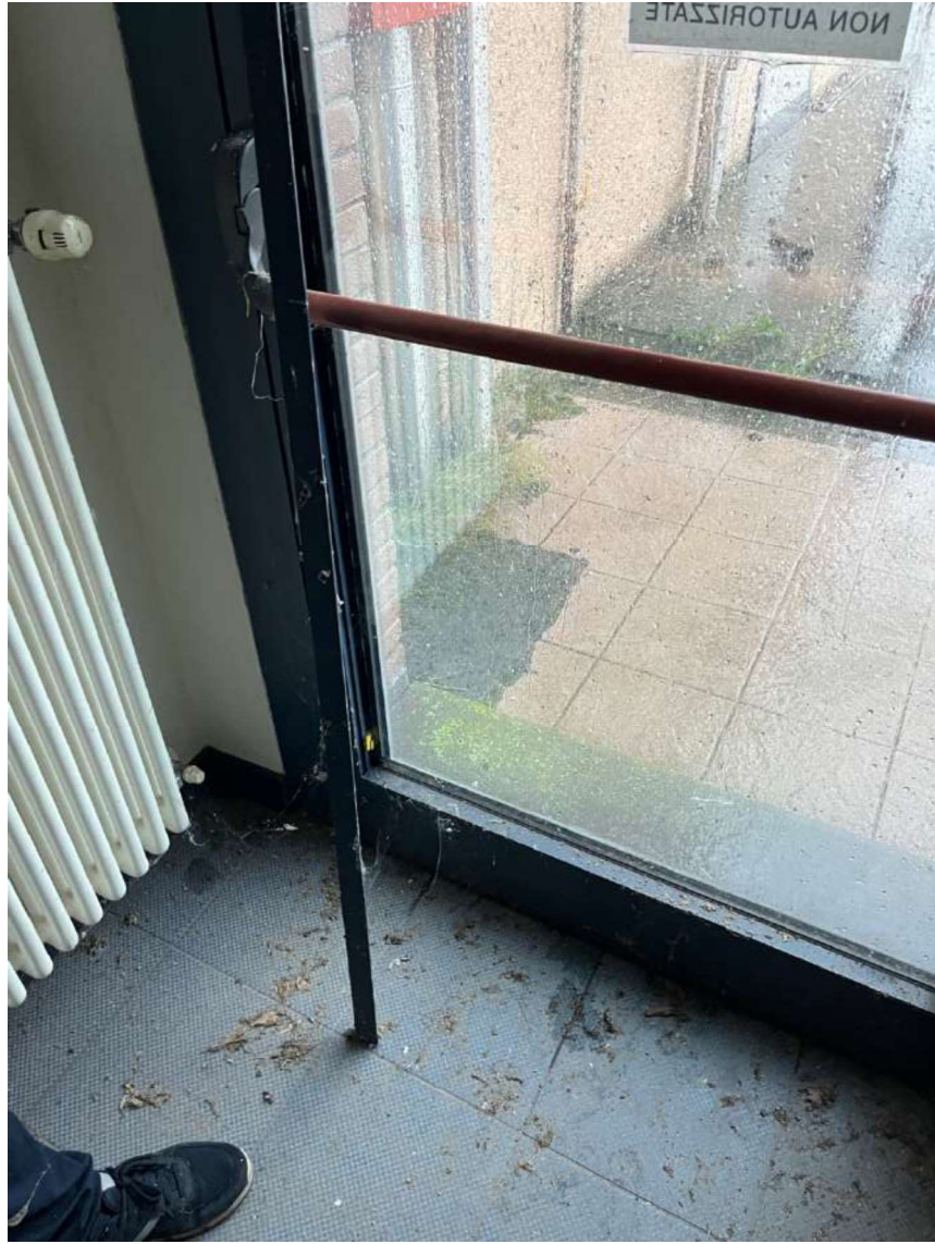
Figura 4- profilo fermavetro rimosso da porta finestra a piano terra
