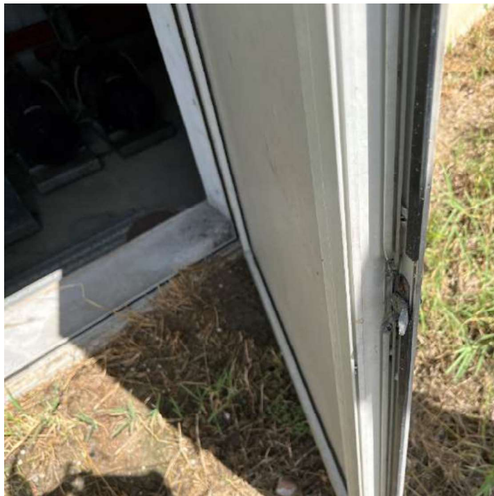
Figura 15 – serratura danneggiata del locale pozzo
