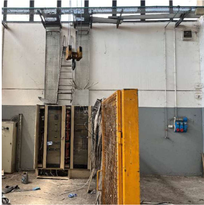
Figura 4- quadro elettrico interno capannone con cavi sfilati
