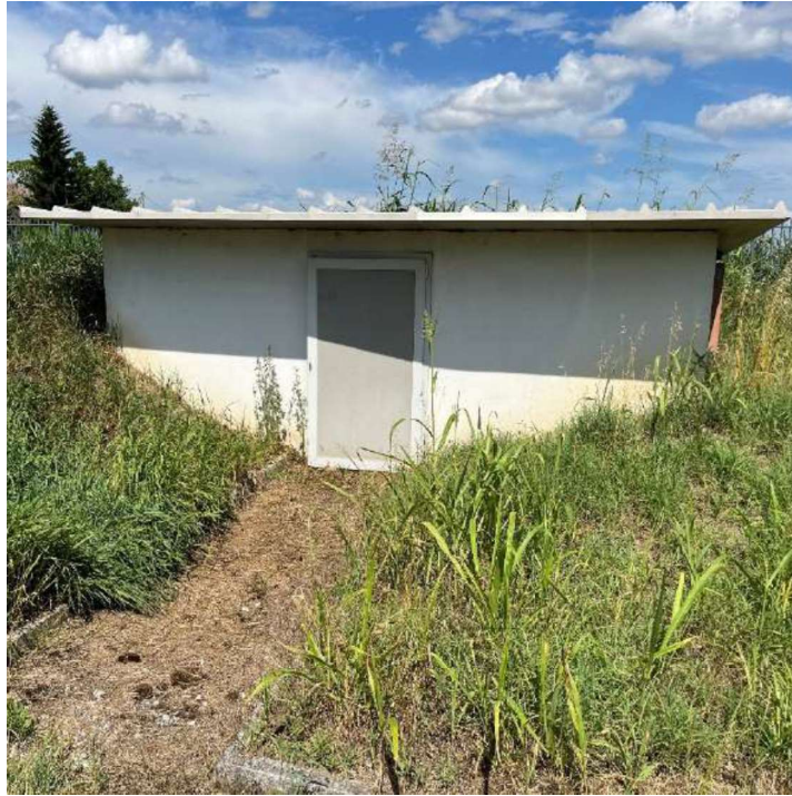
Figura 14 porta con serratura danneggiata del locale pozzo
