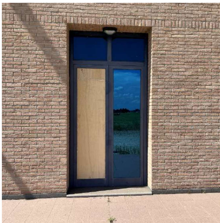
Figura 1 - Portoncino d'ingresso con pannello vetrato rotto e con chiusura temporanea in legno
