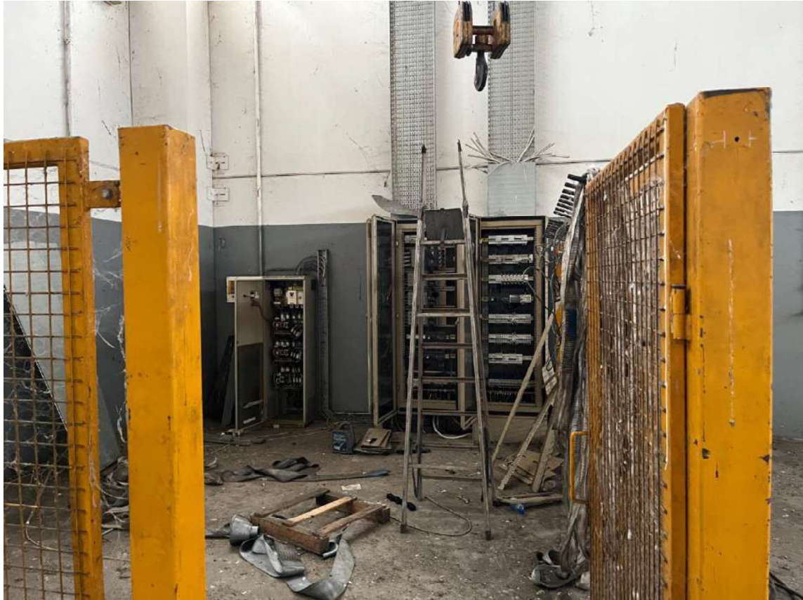
Figura 8- vista interna capannone zona quadri elettrici
