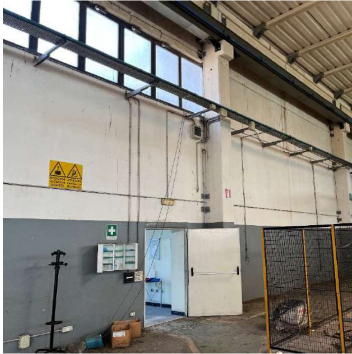
Figura 6- canalette porta cavi vuote senza cavi
