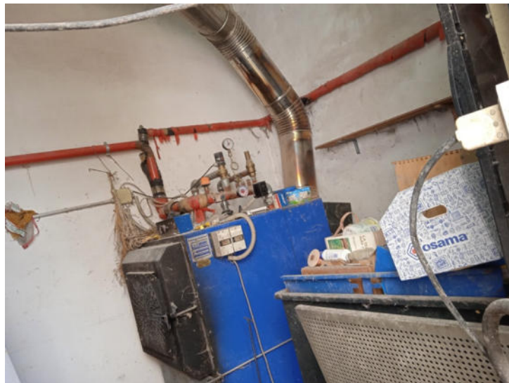
Foto n. 52 – Fabbricato B - Centrale termica - Part. 476 sub1
