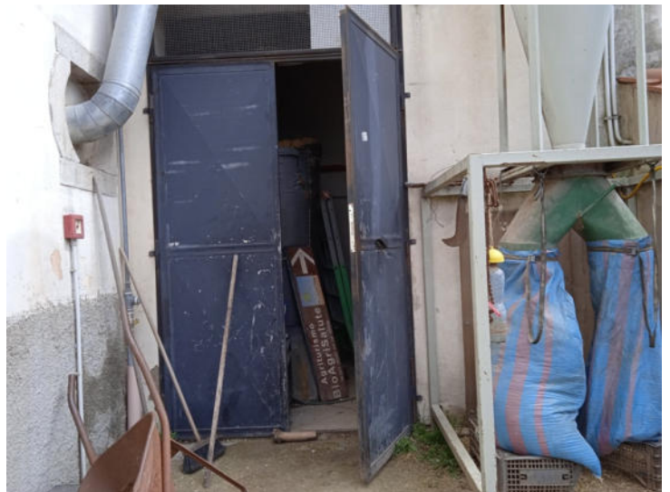
Foto n. 50 – Fabbricato B - Centrale termica - Part. 476 sub1
