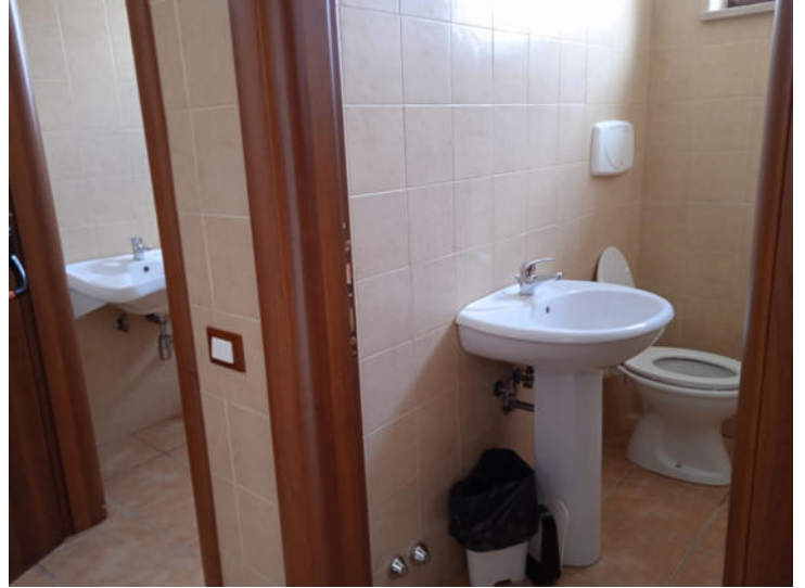
Foto n. 10 – Fabbricato A - Piano terra - Bagni - Part. 477
