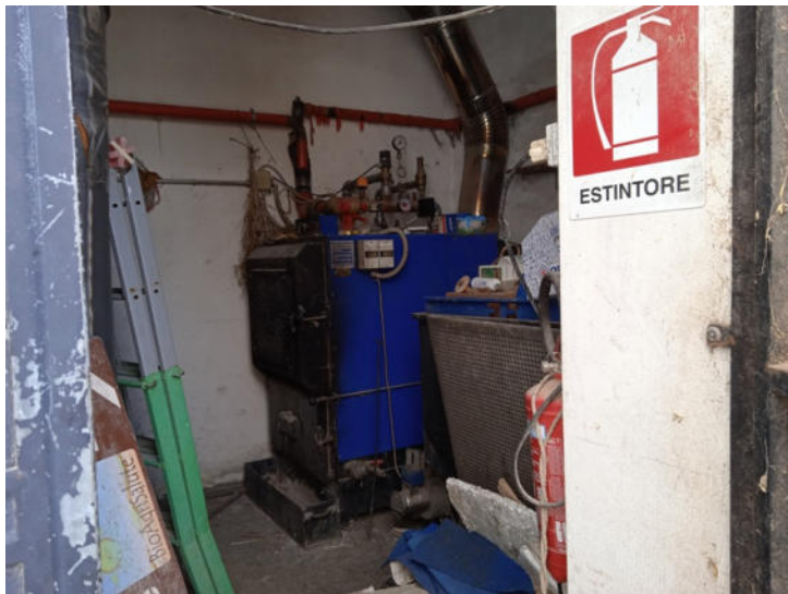
Foto n. 51 – Fabbricato B - Centrale termica - Part. 476 sub1
