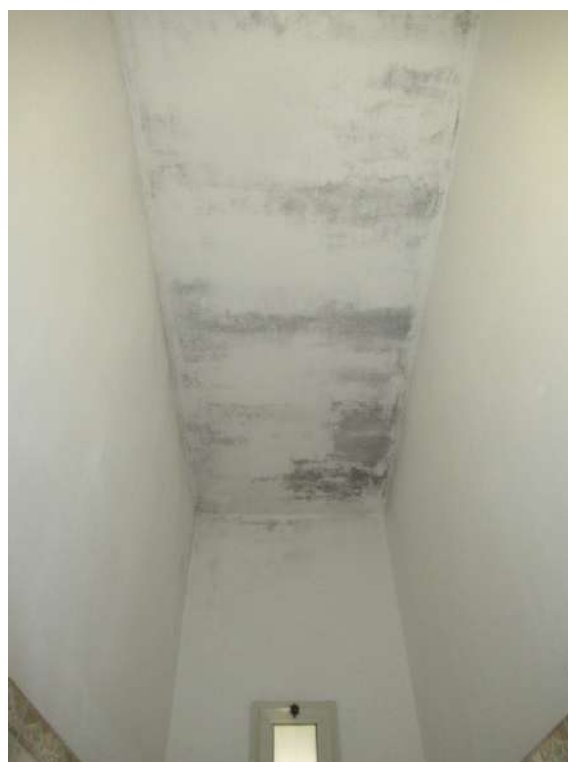
Foto 32_ Degrado su soffitto bagno
