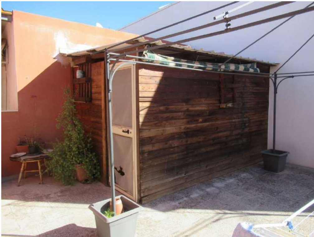
Foto 23_Structura precaria in legno (su terrazza)
