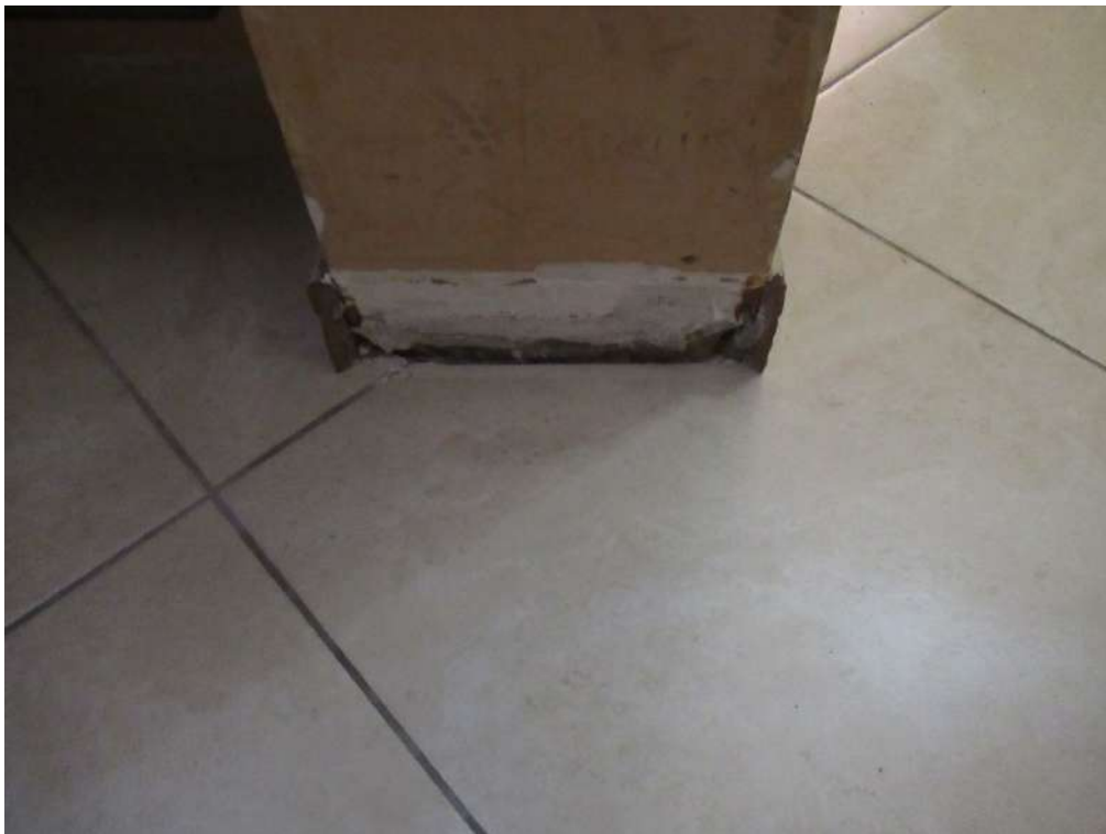
Foto 28_Caduta battiscopa per umidità di risalita su parete
