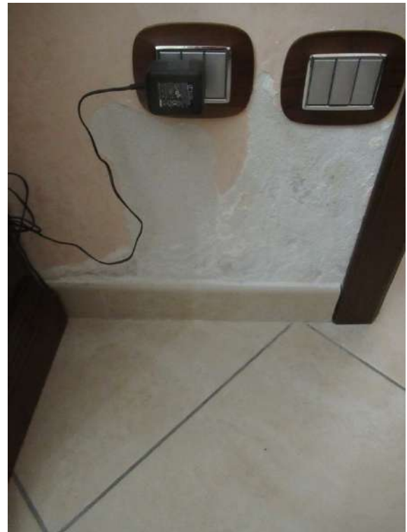
Foto 30_ Umidità di risalita su parete
