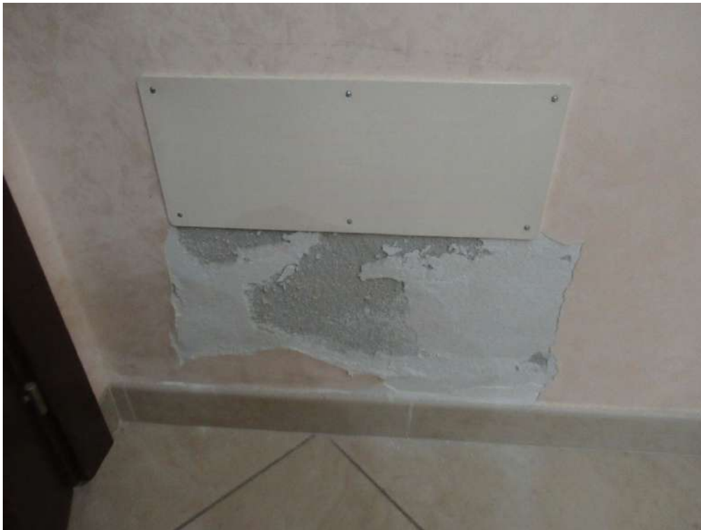
Foto 27_Umidità di risalita su parete
