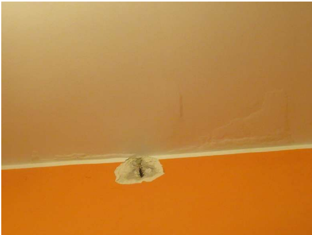
Foto 26_Caduta intonaco su soffitto e sottostante armatura a vista
