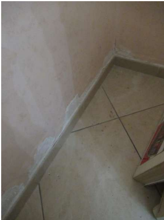
Foto 29_ Umidità di risalita su parete
