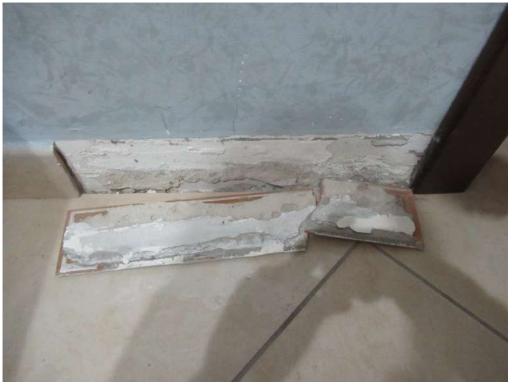
Foto 31_ Caduta battiscopa per umidità di risalita su parete
