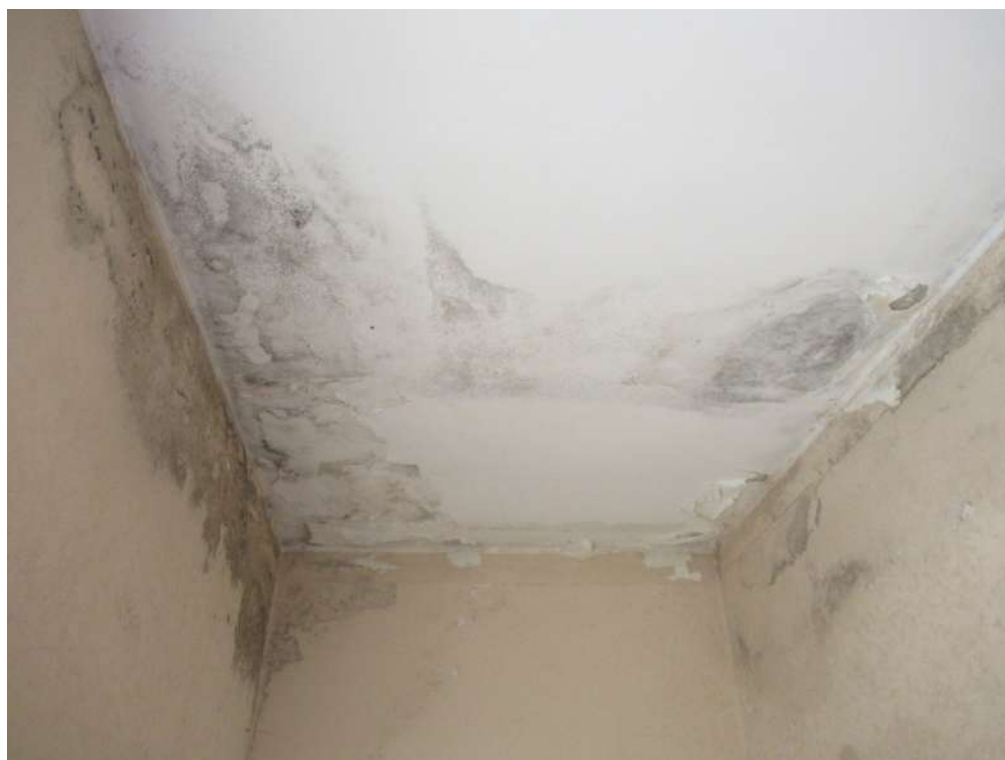
Foto 33_ Degrado su soffitto vano scala
