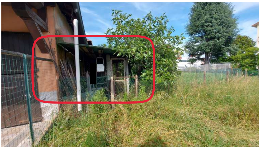
TETTOIA DA RIMUOVERE
