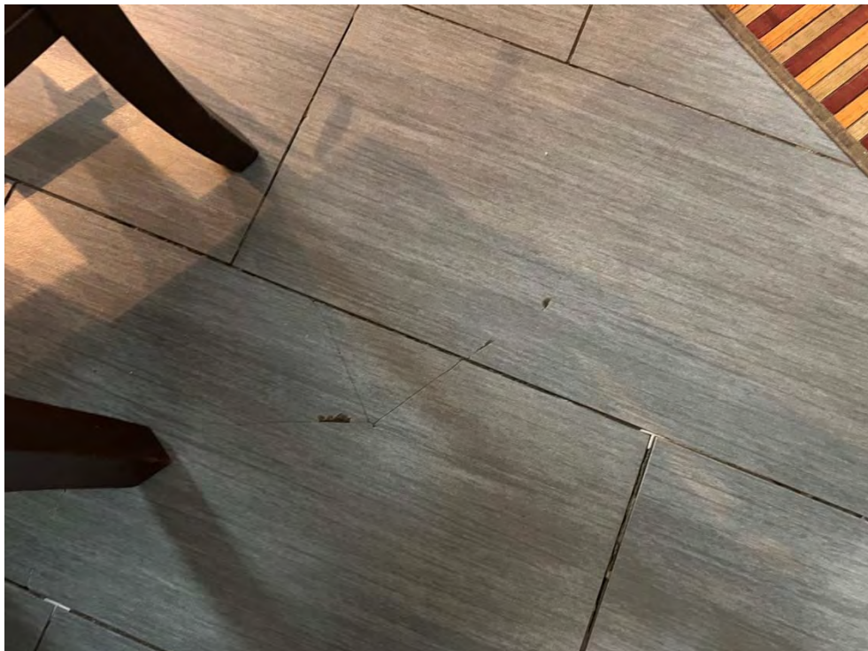
Rottura piastrelle per umidità
