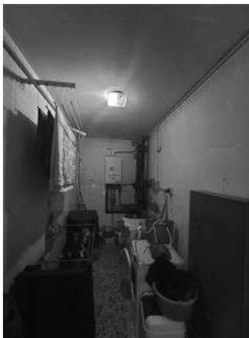
Vista locale p.1 (lav/caldaia)
