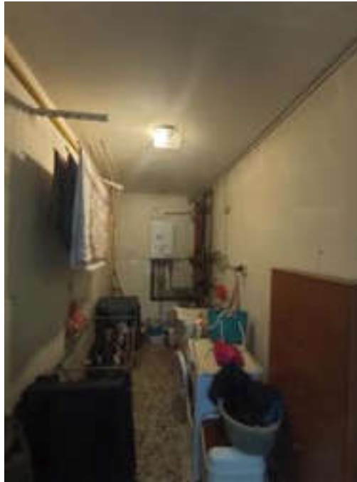
Vista locale pt (lav/caldaia)
