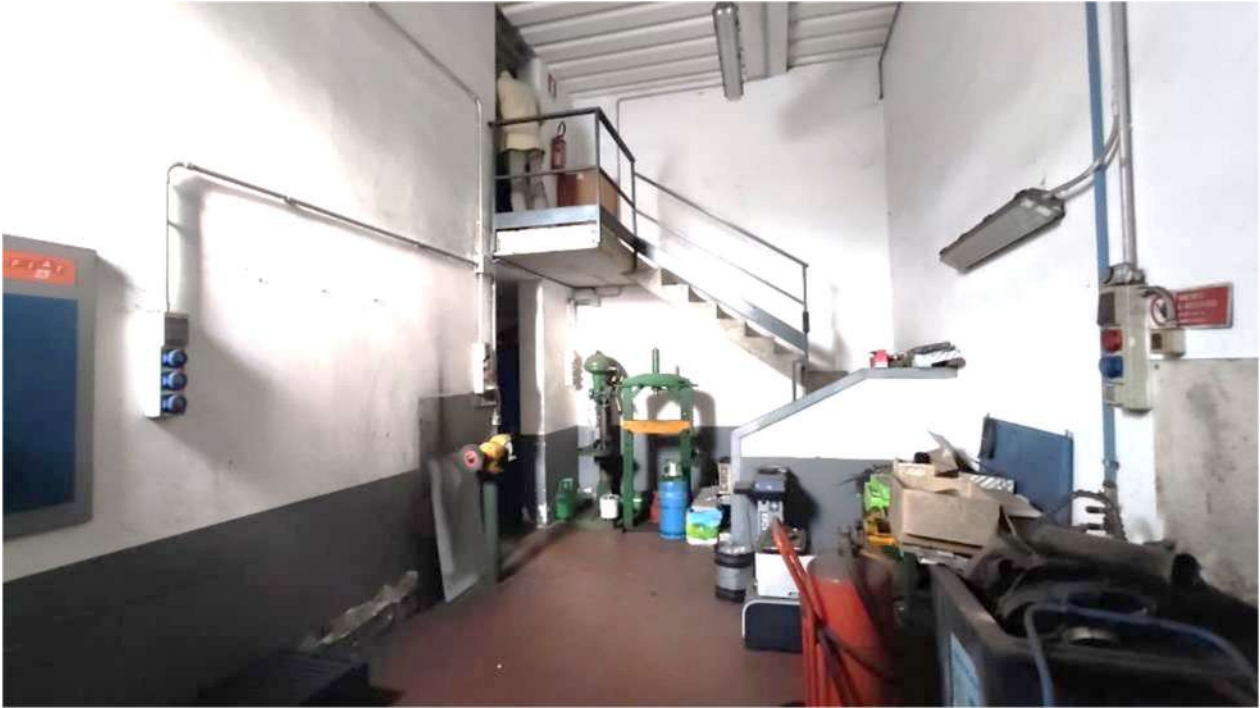
. -Locale tecnico P.T.-
