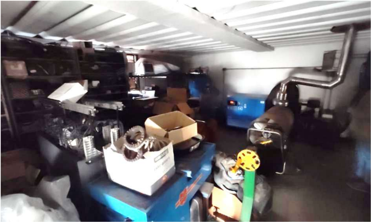
I. -Locale tecnico loc. soppalco -
