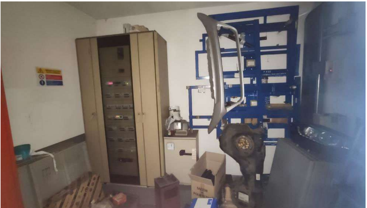
. -Locale tecnico P.T.-
