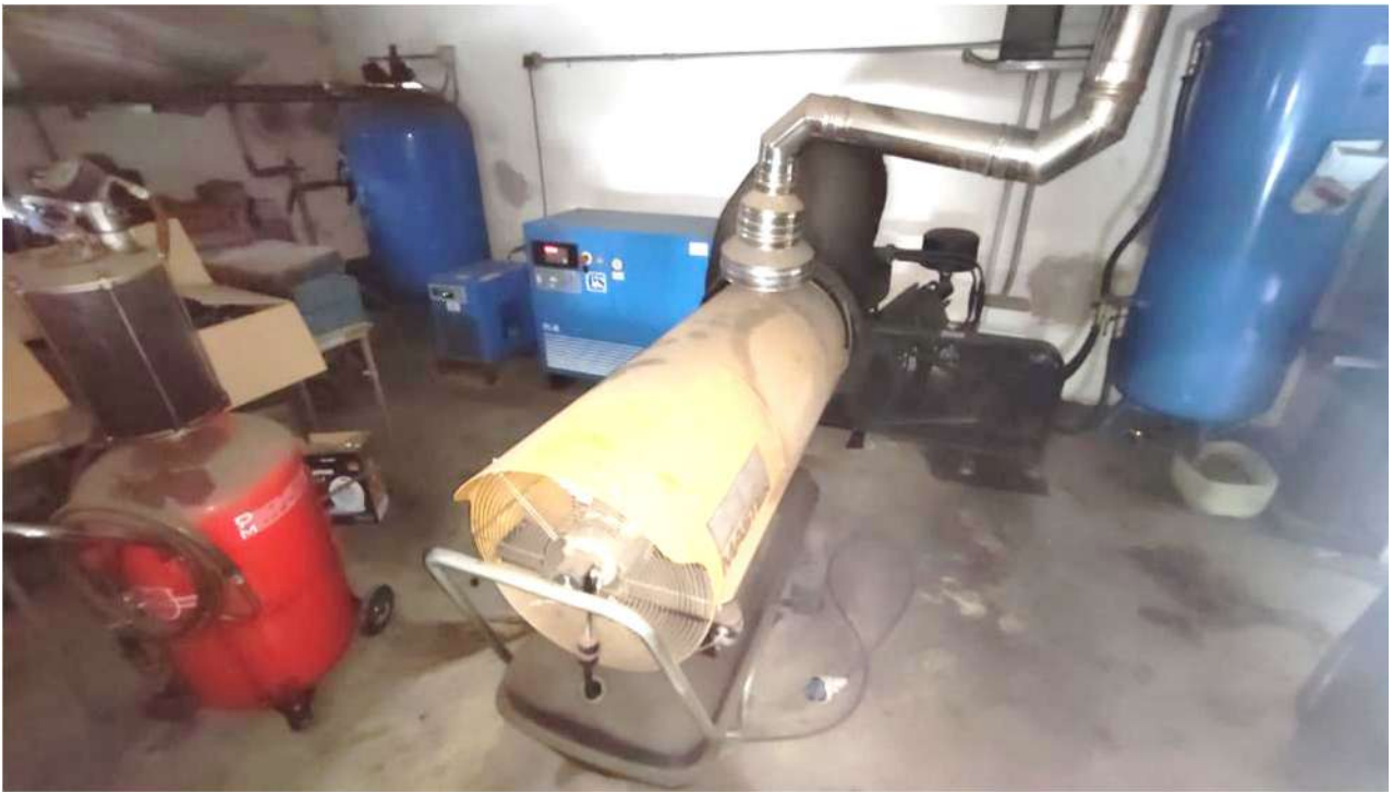
-Locale tecnico loc. soppalco-
