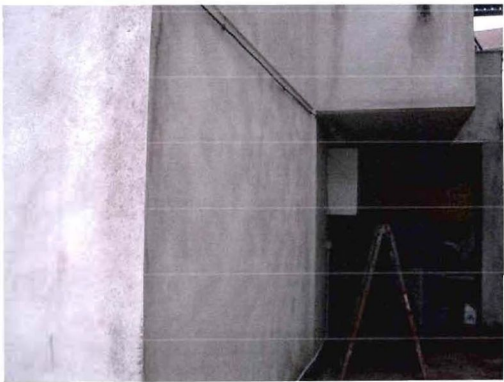
FOTO 6 (Esterno con allocazione Caldaia)
