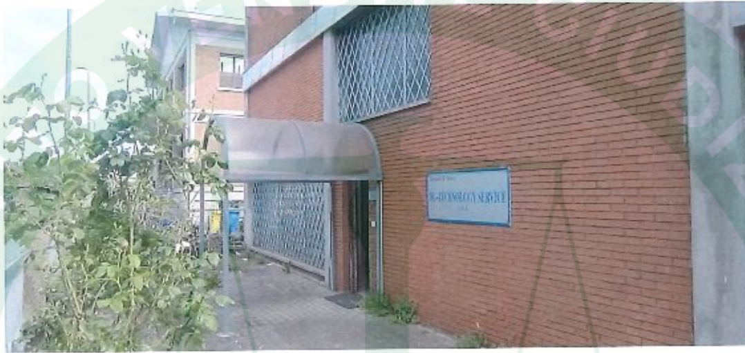
Figura 4 - Tettoia di ingresso non conforme.
