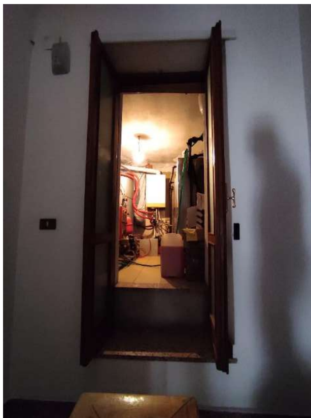
Figura 10- vista 6 sub.8, ingresso al locale tecnico
