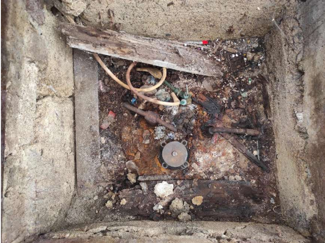
Figura 90- vista 87, botola per cisterna del gasolio interrata al di sotto della via pubblica (C.E. N.106/86)
