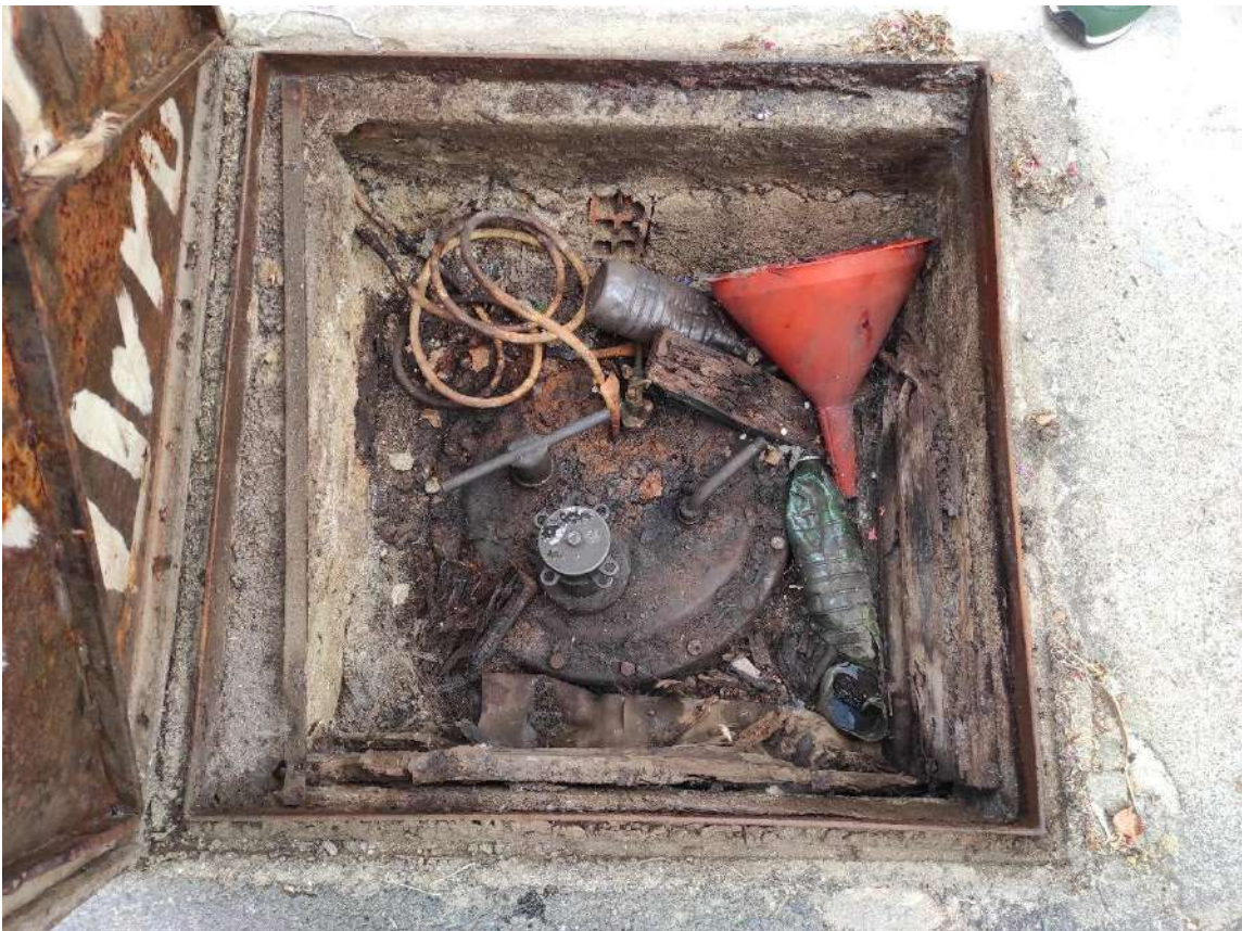
Figura 91- vista 88, botola per cisterna del gasolio interrata al di sotto della via pubblica (C.E. N.106/86)
