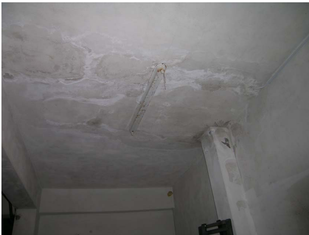
Foto n. 8 Interno lotto 1 – dettaglio intonaco soffitto
