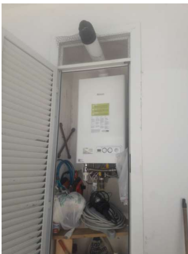
Foto 12 – Vista vano caldaia.
