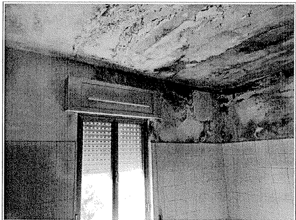
Foto – particolare della zona più colpita dalle infiltrazioni
