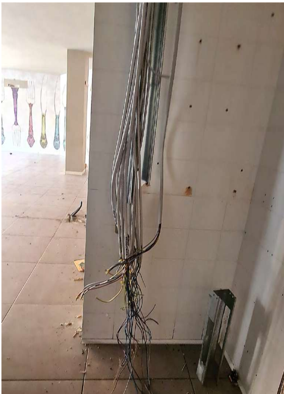
Impianto elettrico danneggiato
