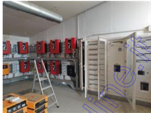
Particolare interni sala inverter
