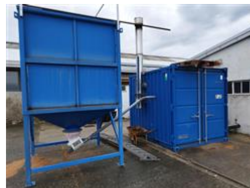
Particolare caldaia a pellets (non in funzione)
