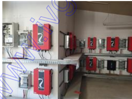
Particolare interni sala inverter
