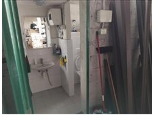
Particolare interni wc
