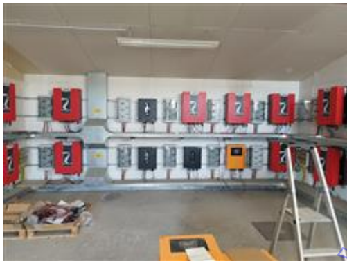
Particolare interni sala inverter
