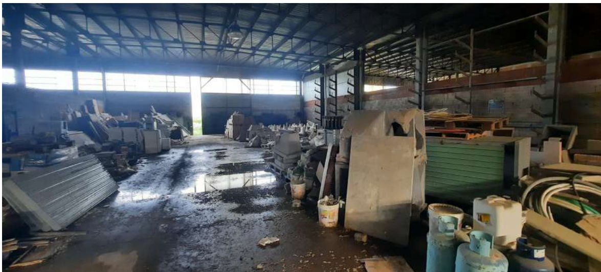
Vista interna – con evidenti infiltrazioni di acqua proveniente dalla copertura
