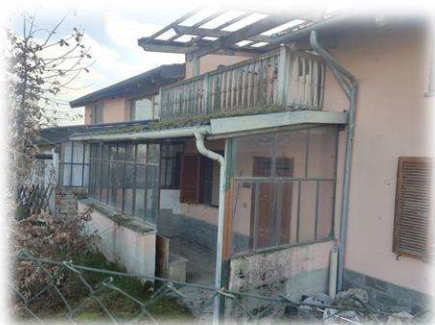
Ingresso attraverso portico verandato abusivamente
