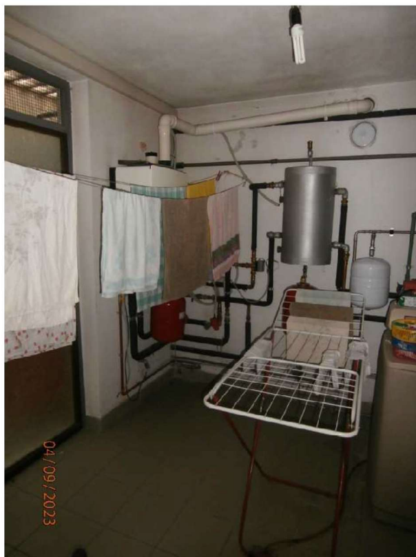
Vista interna centrale termica a piano interrato
