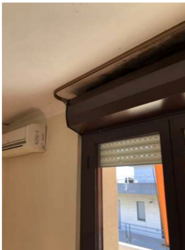
Foto 12: particolare infiltrazioni camera da letto 1
