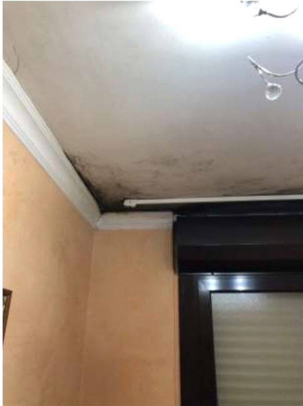
Foto 9: particolare infiltrazioni WC 1
