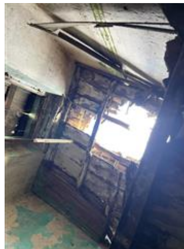
porzione di solaio e di copertura crollati
