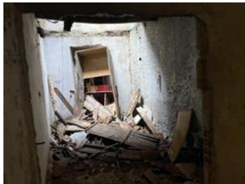
locali di piano primo (con porzione di solaio crollato)
