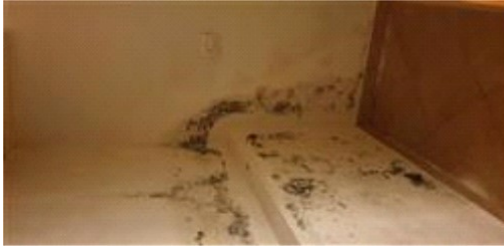
Parete contro terra del ripostiglio
