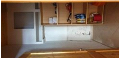
Parete contro terra del ripostiglio
