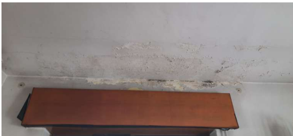
Figura 10 vecchie infiltrazioni solaio locale cucina
