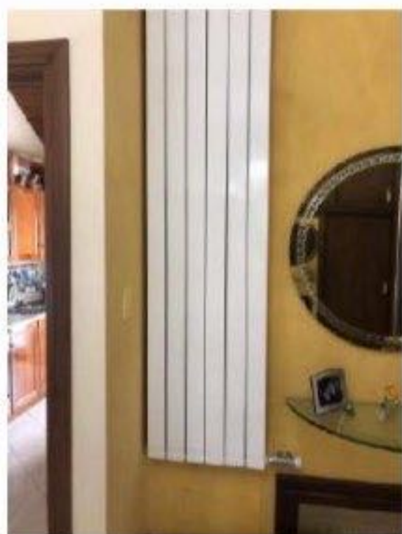
PARTICOLARE CORPI SCALDANTI
