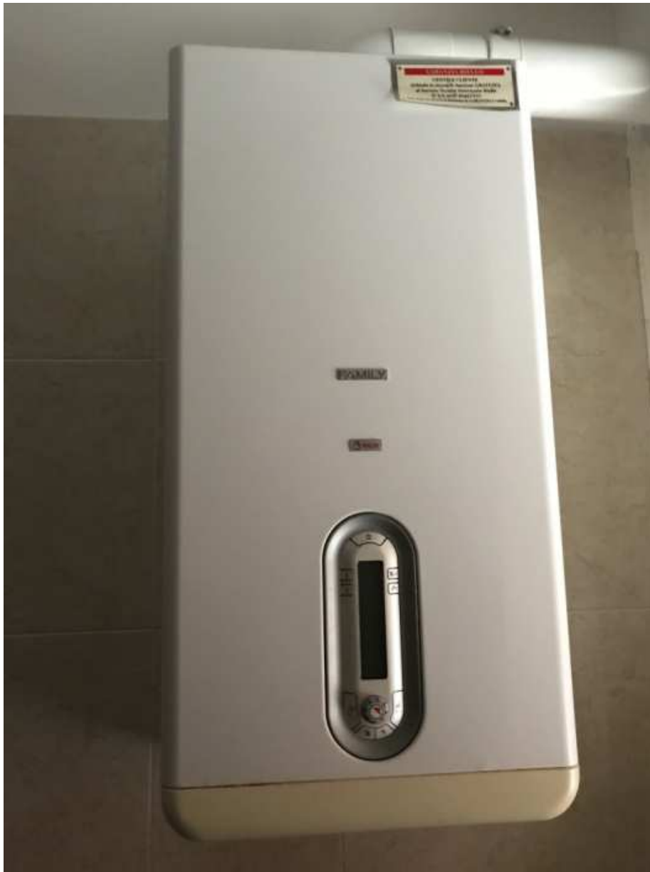
Figura 34 - Caldaia primo piano
