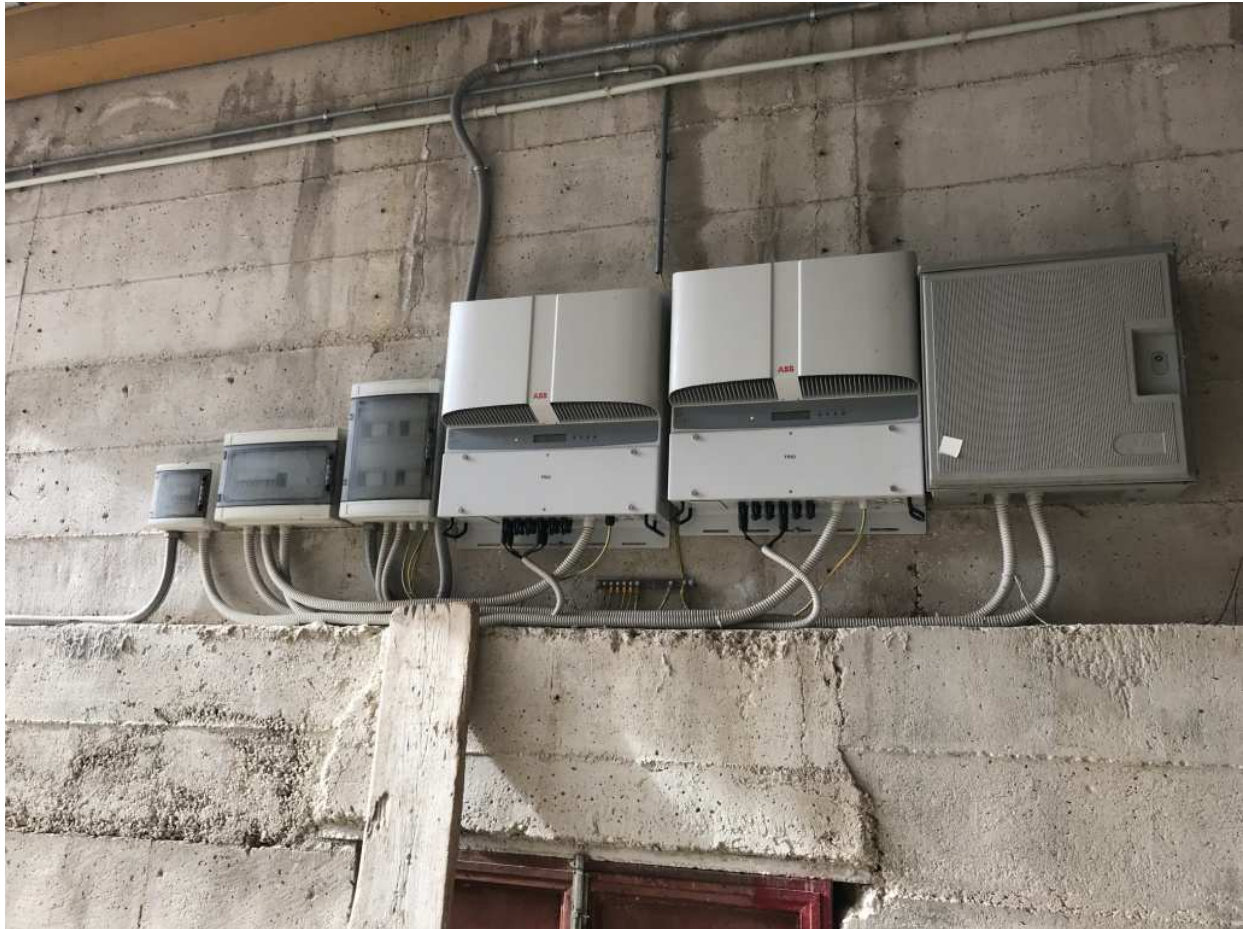
Figura 37 – Inverter e quadri elettrici impianto fotovoltaico
