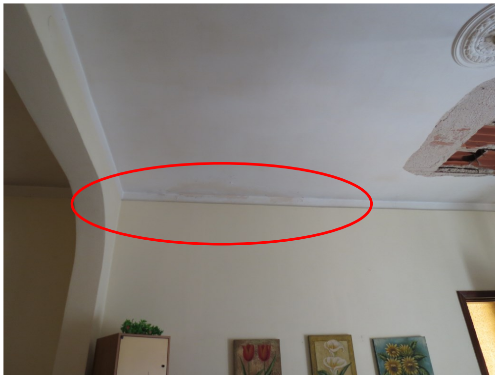
Foto 7: Macchia di umidità nel salone.
