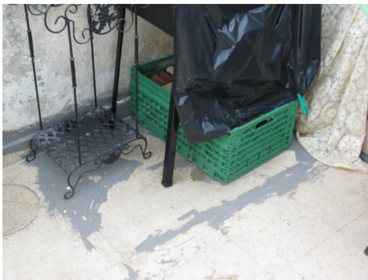
Foto 13: Intervento di riparazione nel terrazzino soprastante la cucina in pessimo stato di manutenzione.
