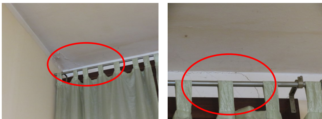
Foto 8-9: Tracce di umidità e lesioni in corrispondenza della finestra che si affaccia sul cavedio.
