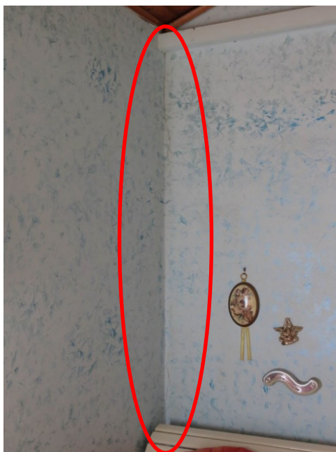
Foto 6: Lesione presente nello spigolo della cameretta in corrispondenza del terrazzino.
