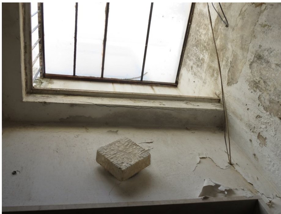
Foto 10: Lesione sul cordolo soprastante la finestra.
