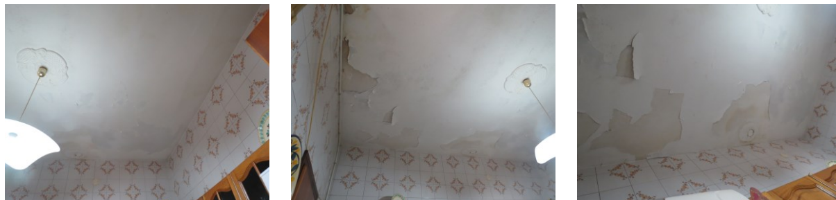
Foto 11-12-13: Tracce di umidità con scrostamento della tinteggiatura nel soffitto della cucina.
