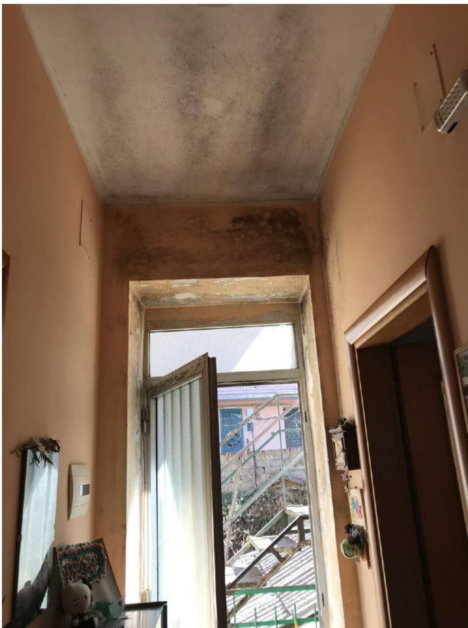
Entrata, disimpegno appartamento primo piano. Macchie d'umidità soffitto.
