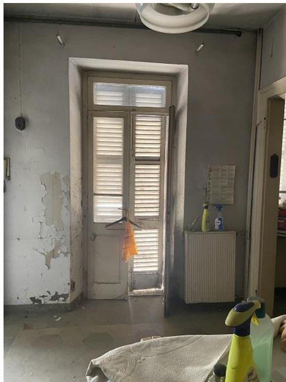
Foto 15: Appartamento – Porta finestra cucina.
