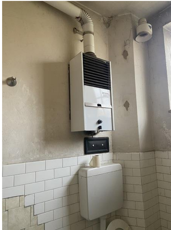
Foto 12: Appartamento – Caldaia posizionata nel bagno.
